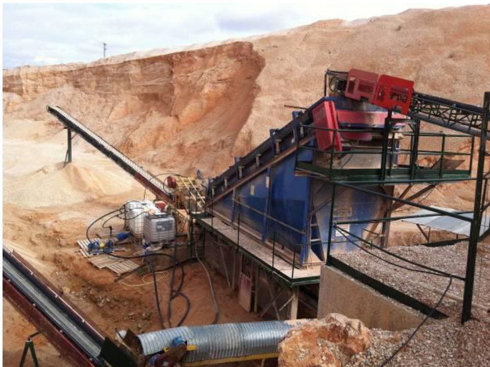
Figura 10. Detalle de la planta experimental de recuperación de estériles
