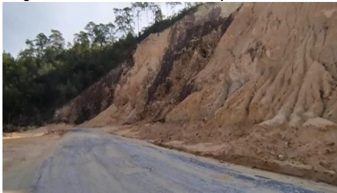
Imagen 6. Infraestructura vial afectada por derrumbes.
