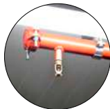
Detalle de rociador.
