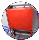
Detalle del depósito.
