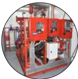
Equipo Contra Incendios
