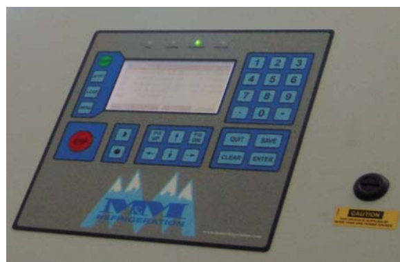
Armario de maniobra para controlar los compresores en la sala de máquinas
