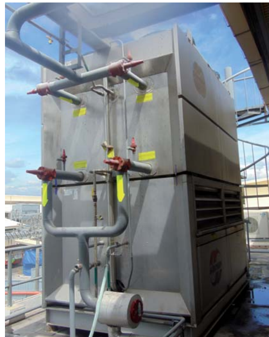
Dos condensadores evaporativos ECOSS de Güntner disipan el exceso de calor de los compresores de NH 3 al entorno
