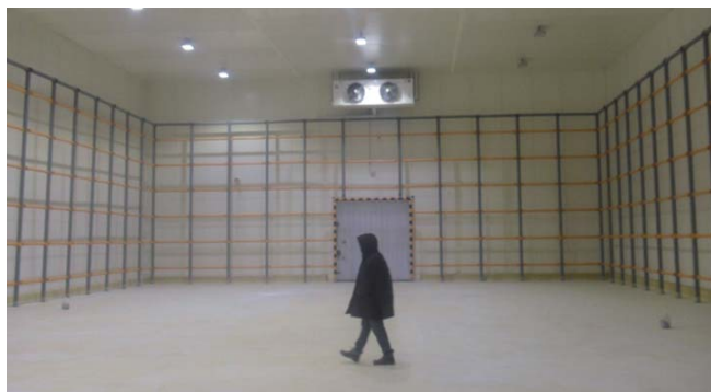
Una cámara de congelación para 1000 toneladas métricas/1102 toneladas americanas es refrigerada por dos evaporadores CUBIC Vario CPGHN de Guntner, dispuestos en ambos extremos de la cámara uno enfrente del otro
