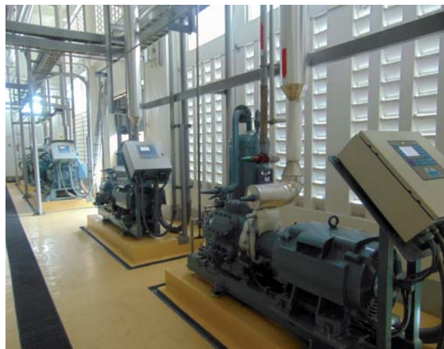
Compresores de NH 3 y de CO 2 en la sala de máquinas
