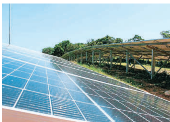
La parte del componente solar de la planta híbrida está compuesta de 1,121 paneles solares en su primera etapa.
