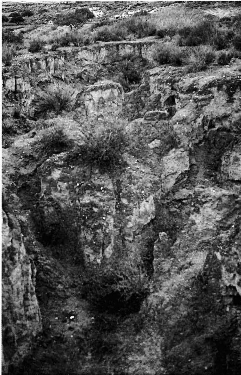
Fig. 4.—Aspecto de la cárcava originada por hundimiento de la bóveda y evacuación de sedimentos, en los materiales neógeno-cuaternarios del Campo de Mazarrón. Terreno cultivado hasta el año 1972 y posteriormente abandonado (23.5.85).
