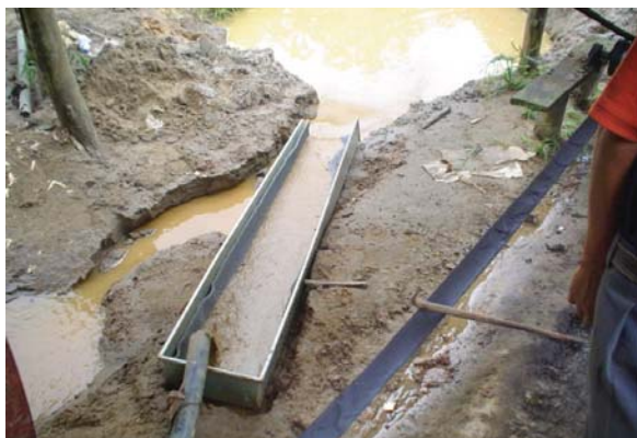
Foto 8: Canaleta mina Esparta. Foto: CORPONARIÑO
