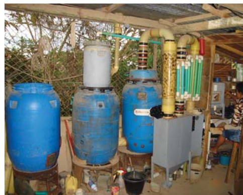
Foto 35: Depurador en Seco - Recirculación del vapor a través de trampas. Foto: Geominas
