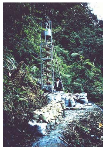
Foto 29: Concentradores de espiral. Proyecto Río Surata. Foto CDMB
