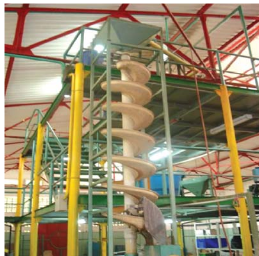
Foto 28: Concentradores de espiral. Proyecto Río Surata. Foto CDMB
