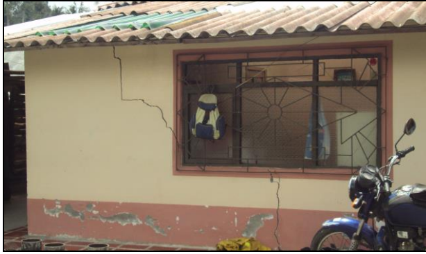
Vivienda afectada por el último sismo, año 2012 en la vereda Panamá.
