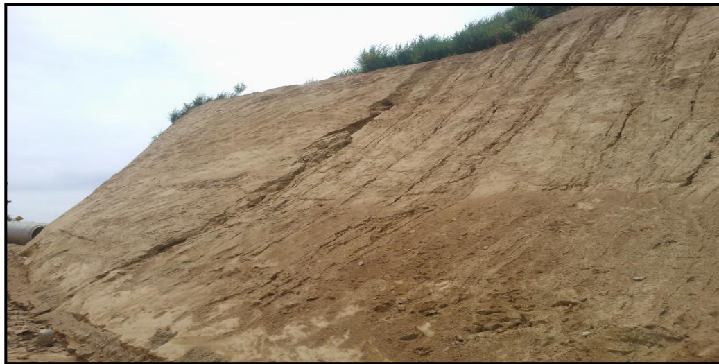
Figura A2. Falla causada por los efectos de la erosión en un terreno
