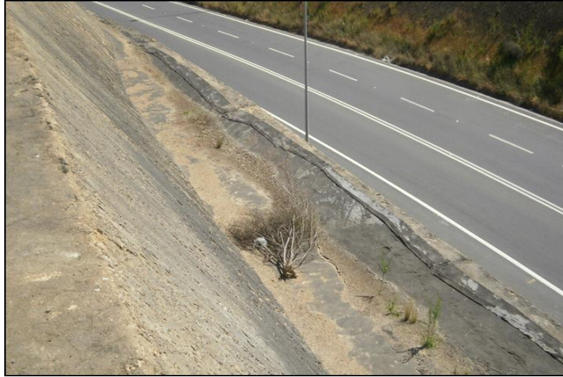
Figura N°5. Geomembrana despegada producto de la acción del viento
