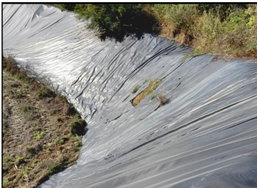
Figura A9. Geomembrana rota producto de la erosión
