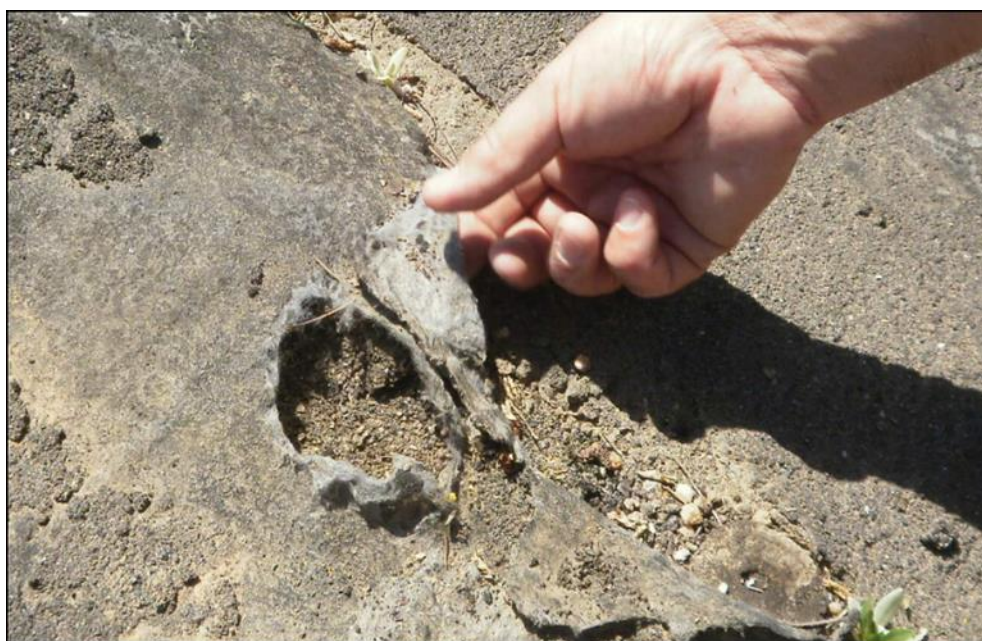
Figura A10. Geotextil rasgado producto de punzonamientos
