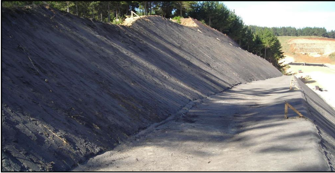
Figura N° 6. Fotografía de terraza recubierta por asfalto cortado
