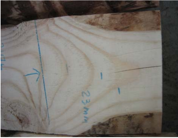
Grietas de testa
