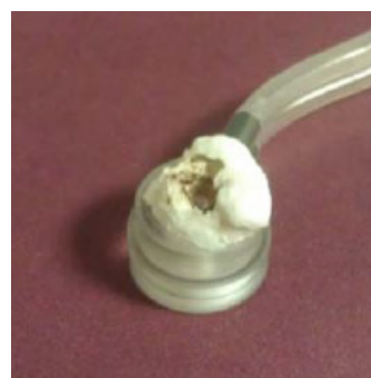
Cabezal de lavado con gran acumulación de sal en la superficie
