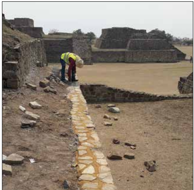
Reintegración de rellenos, resane y restauración de muros en el primer y segundo cuerpo del lado norte / Foto: Archivo Técnico Proyecto de Conservación de los Edificios Dañados por los Sismos de 2017 en Monte Albán-Atzompa.
