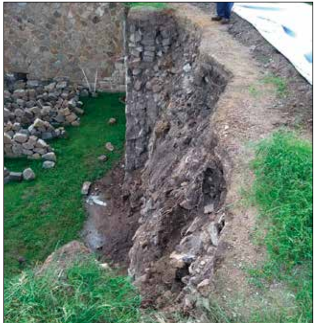
Daños en el cabezal sur, foto tomada en planta / Foto: Archivo Técnico Proyecto de Conservación de los Edificios Dañados por los Sismos de 2017 en Monte Albán-Atzompa.
