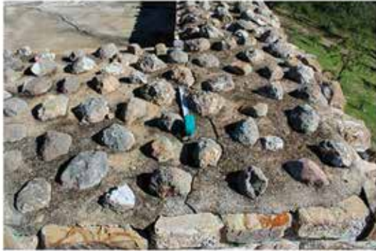
1. Grieta en nucleado del muro cajón.
