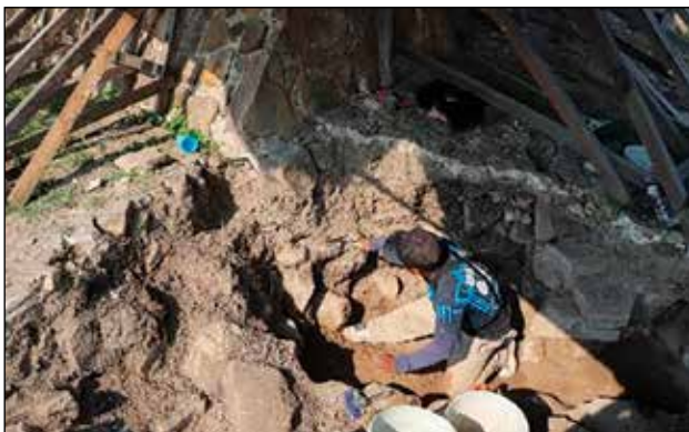
Registro de la cimentación de la esquina noreste para fortalecer su estructura y resane / Foto: Archivo Técnico ZAMA, 2019.
