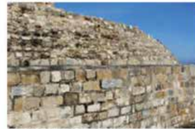
6.- DESPRENDIMIENTO DE ESTUCO MODERNO
