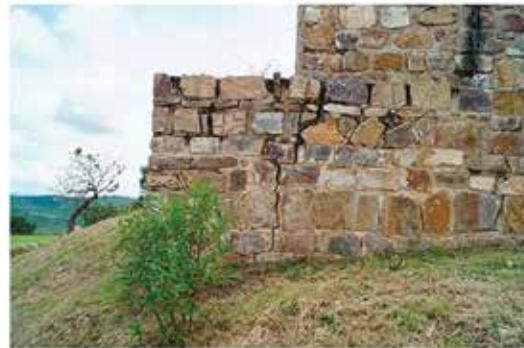
Afectación muro E, primer cuerpo esquina noreste. Edificio 16.
