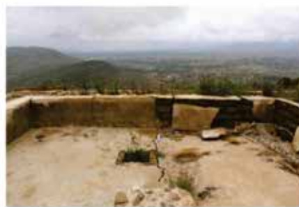
3.- DESPRENDIMIENTO DE APLANADOS EN MUROS DE ADOBE
