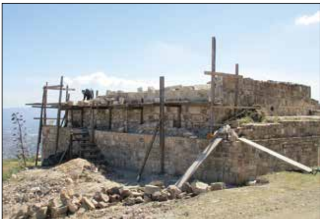
Fachada oriente del Edificio 16. Reintegración de sillares de piedra en el muro del segundo cuerpo / Foto: Archivo Técnico Proyecto de Conservación de los Edificios Dañados por los Sismos de 2017 en Monte Albán-Atzompa.
