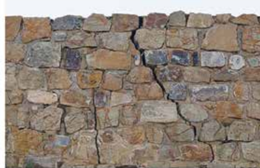
Vista dellate afectación muro M, segundo cuerpo de fachada este. Edificio 16.
