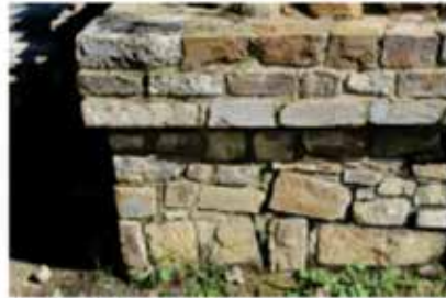
1.- GRIETA EN CORNISA
