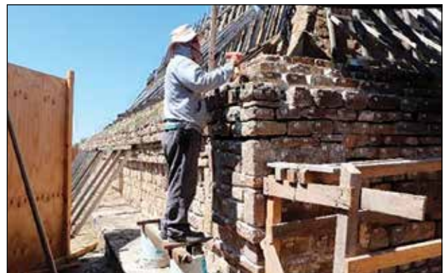
Liberación de junta constructiva en el tablero de la esquina noreste / Foto: Archivo Técnico ZAMA, 2019.
