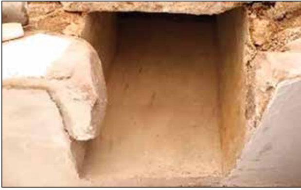
Integración de estuco de sacrificio en el piso del desagüe / Foto: Archivo Técnico ZAMA, sismos de 2017.
