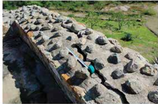
2. Separación de elementos del muro de cajón.
