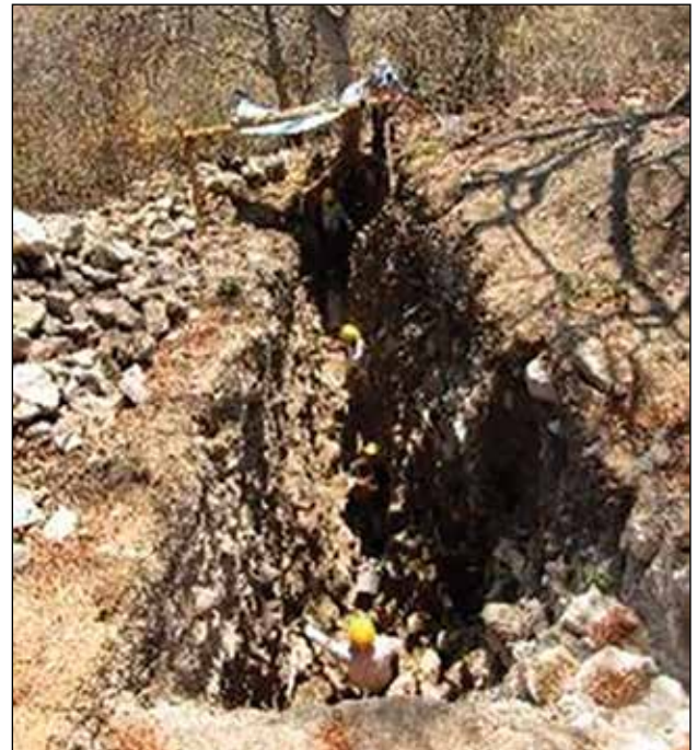
Procesos de consolidación del desagüe este / Foto: Archivo Técnico ZAMA, sismos de 2017.
