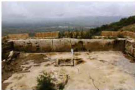
1.- DESPRENDIMIENTO DE APLANADOS EN MUROS DE ADOBE
