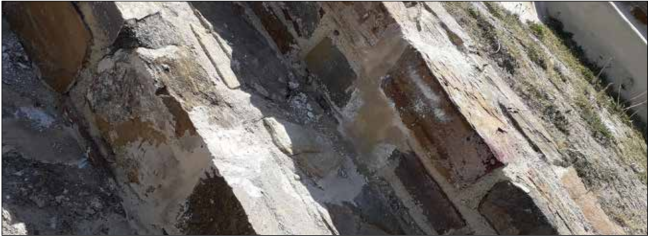
Consolidación de elementos dañados mediante inyección y sellado de grietas / Foto: Archivo Técnico Proyecto de Conservación de los Edificios Dañados por los Sismos de 2017 en Monte Albán-Atzompa.
