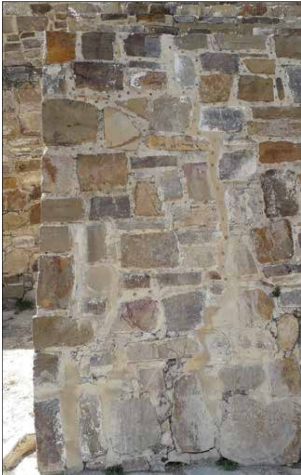
Consolidación de elementos dañados mediante inyección y sellado de fisuras / Foto: Archivo Técnico Proyecto de Conservación de los Edificios Dañados por los Sismos de 2017 en Monte Albán-Atzompa.
