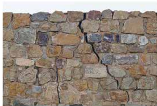
4. Grieta en el arranque del muro.
