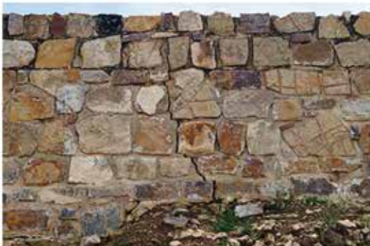
Afectación muro L, segundo cuerpo esquina noreste. Edificio 16.
