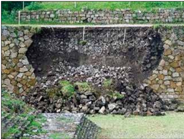
Colapso del muro sur, cabezal sur / Foto: Archivo Técnico ZAMA, sismos de 2017.
