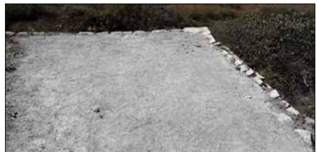
Colocación de relleno compactado de tierra con cal química / Foto: Archivo Técnico Proyecto de Conservación de los Edificios Dañados por los Sismos de 2017 en Monte Albán-Atzompa.
