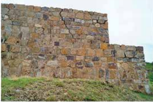
Afectación muro M, segundo cuerpo de fachada este. Edificio 16.
