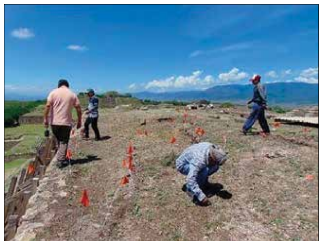
Colocación de banderillas para identificar la grieta provocada por el sismo en el Edificio A / Archivo Técnico Proyecto Conservación de los Edificios Dañados por los Sismos de 2017 en Monte Albán-Atzompa.
