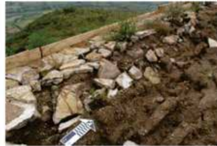
2.- COLAPSO DE MURO DE ADOBE
