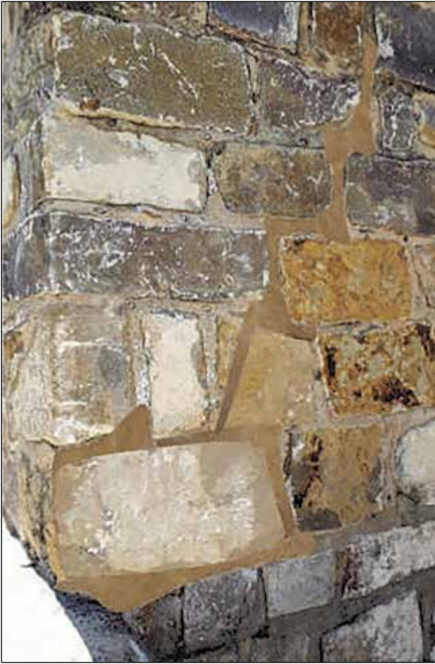
Grieta de la esquina noreste del Edificio 6 mostrando fractura de piedra esquinera / Foto: Archivo Técnico Proyecto de Conservación de los Edificios Dañados por los Sismos de 2017 en Monte Albán-Atzompa.
