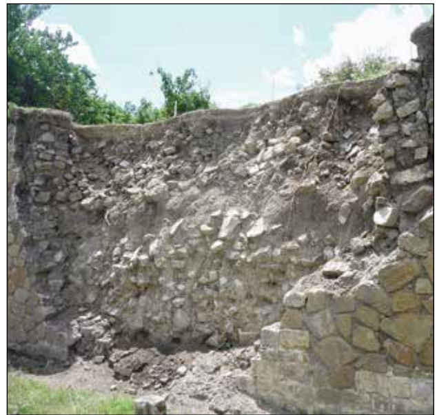
Daños en el cabezal sur del Juego de Pelota de Monte Albán ocasionados por el sismo / Foto: Archivo Técnico Proyecto Conservación de los Edificios Dañados por los Sismos de 2017 en Monte Albán-Atzompa.
