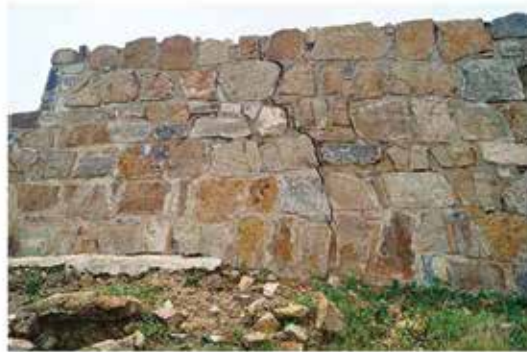
3. Grieta en muro superior.
