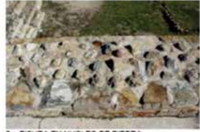
3.- FISURA EN NUCLEO DE PIEDRA
