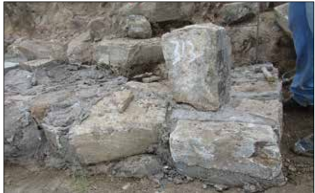
Fachada oriente. Esquina noreste del Edificio 16. Se integró y consolidó una base con piedra arenisca antes de iniciar el desplante de muro / Foto: Archivo Técnico Proyecto de Conservación de los Edificios Dañados por los Sismos de 2017 en Monte Albán-Atzompa.
