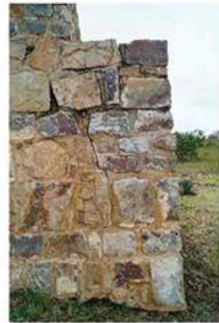
6. Grieta en el desplante del edificio.
