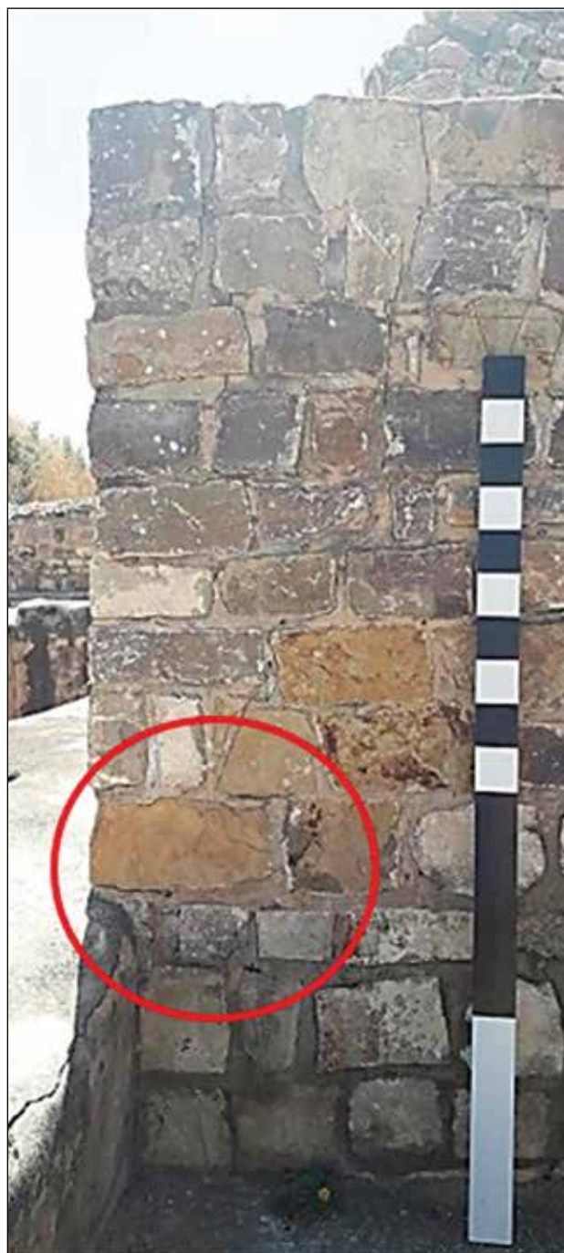
Grieta de la esquina noreste del Edificio 6 con reintegración de piedra esquinera / Foto: Archivo Técnico Proyecto de Conservación de los Edificios Dañados por los Sismos de 2017 en Monte Albán-Atzompa.
