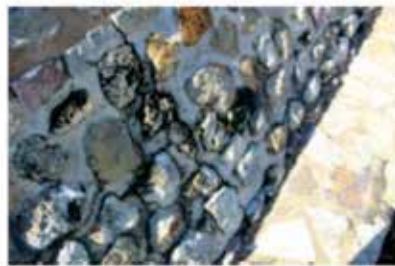
4.- GRIETA EN MURO NUCLEO
