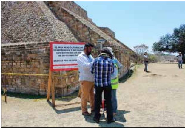
Letrero restrictivo y colocación de cinta restrictiva / Archivo Técnico Proyecto Conservación de los Edificios Dañados por los Sismos de 2017 en Monte Albán-Atzompa.
