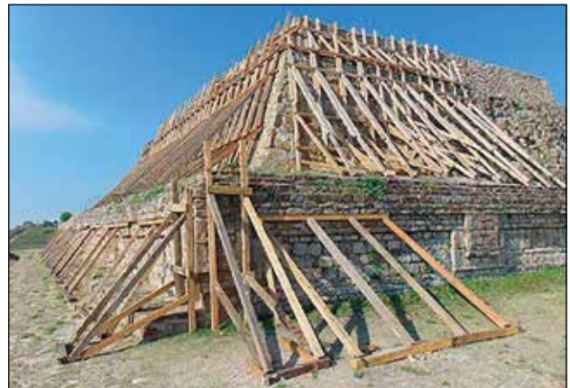
Zona Arqueológica de Monte Albán. Acciones emergentes: apuntalamiento de la fachada noreste del Edificio A después del sismo del 7 de septiembre; con el sismo del 19 de septiembre la fachada se recargó en el apuntalamiento / Foto: Julio Manlio Zúñiga Cruz.
