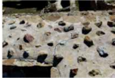
2.- GRIETA EN MURO CAJON DEL TEMPLO
