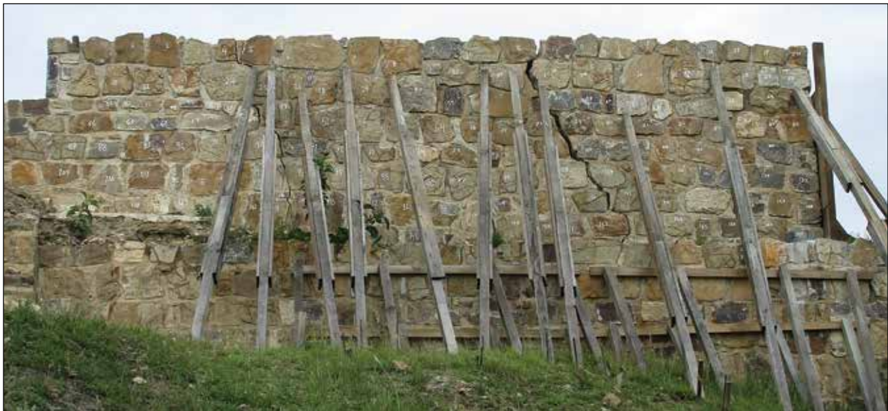
Fachada oriente. Estado de conservación / Foto: Archivo Técnico Proyecto de Conservación de los Edificios Dañados por los Sismos de 2017 en Monte Albán-Atzompa.
