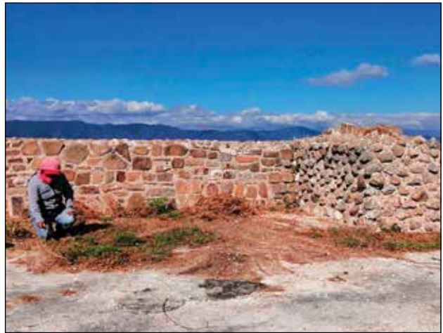
Templo del Edificio IV. Estado de conservación / Foto: Archivo Técnico Proyecto de Conservación de los Edificios Dañados por los Sismos de 2017 en Monte Albán-Atzompa.
