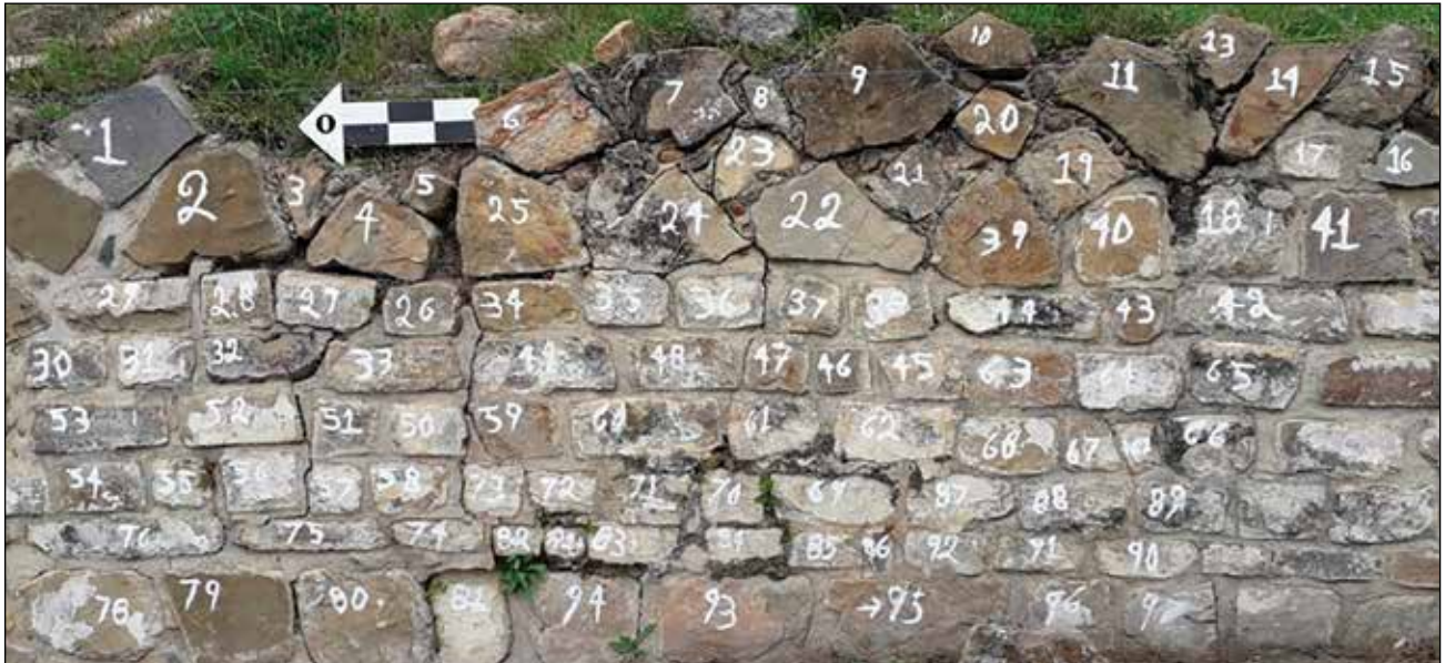
Sección del muro dañada por efecto del sismo, mostrando grietas y desplomes. Numeración para hacer anastilosis / Foto: Archivo Técnico Proyecto de Conservación de los Edificios Dañados por los Sismos de 2017 en Monte Albán-Atzompa.
