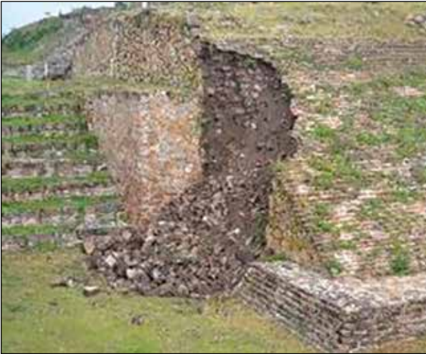
Colapso del muro talud oeste / Foto: Archivo ZAMA, sismos del 2017.
