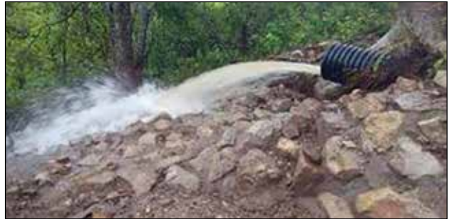
Vista del tubo instalado que conduce el agua de la Plaza Principal por el Juego de Pelota hacia la ladera este / Foto: Archivo Técnico ZAMA, sismos de 2017.
