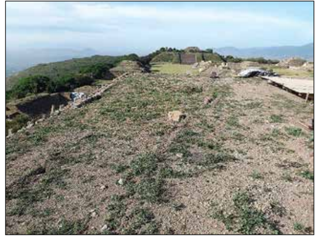
Cima del Edificio A donde se observan las grietas longitudinales en la parte este / Foto: Archivo Técnico Proyecto de Conservación de los Edificios Dañados por los Sismos de 2017 en Monte Albán-Atzompa.
