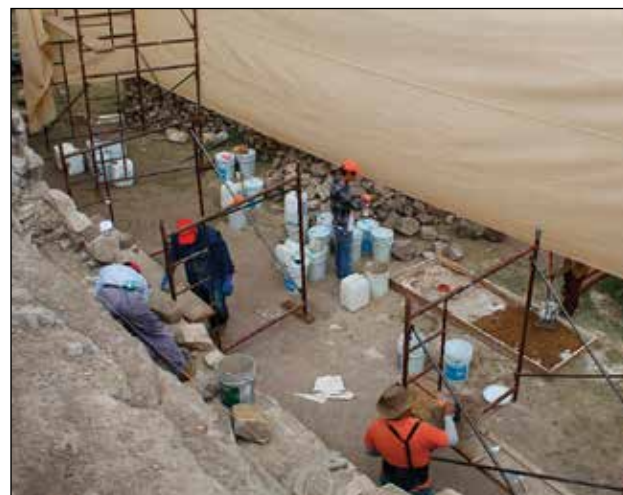
Procesos de restauración del cabezal sur del Juego de Pelota / Foto: Archivo Técnico Proyecto de Conservación de los Edificios Dañados por los Sismos de 2017 en Monte Albán-Atzompa.
