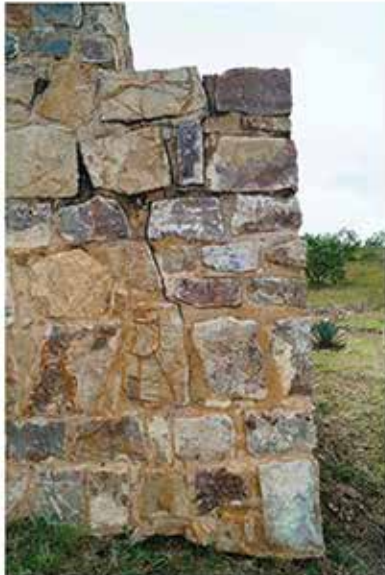
Afectación muro F, primer cuerpo esquina noreste. Edificio 16.
