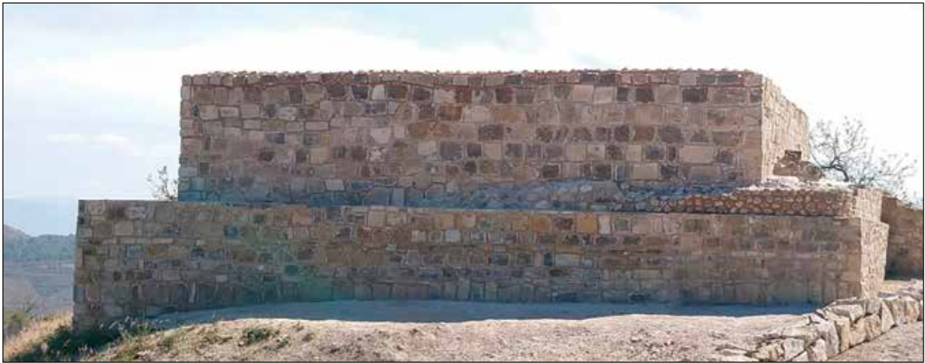
Estado de la fachada norte del Edificio 16 al final de los trabajos / Foto: Archivo Técnico Proyecto de Conservación de los Edificios Dañados por los Sismos de 2017 en Monte Albán-Atzompa.
