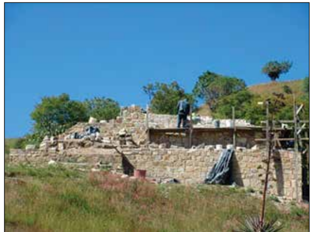
Fachada oriente del Edificio 16. Reintegración de sillares de piedra en el muro del primer y segundo cuerpo / Foto: Archivo Técnico Proyecto de Conservación de los Edificios Dañados por los Sismos de 2017 en Monte Albán-Atzompa.
