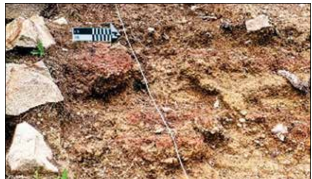
En esta imagen se observa la utilización de firmes de barro cocido, en la sección superior de la fachada este, esquina sur / Foto: Archivo Técnico Proyecto Conservación de los Edificios Dañados por los Sismos de 2017 en Monte Albán-Atzompa.
