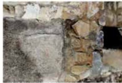
5.- PROLONGACION DE LA GRIETA DEL MURO NORTE
