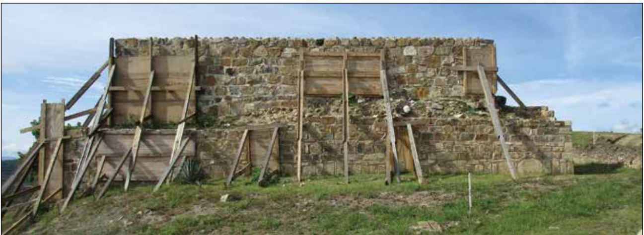
Fachada norte del Edificio 16. Estado de la fachada al inicio de los trabajos / Foto: Archivo Técnico Proyecto de Conservación de los Edificios Dañados por los Sismos de 2017 en Monte Albán-Atzompa.
