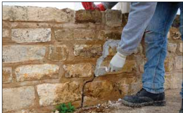
Edificio 6. Intervención en grieta del templo muro oeste / Foto: Archivo Técnico Proyecto de Conservación de los Edificios Dañados por los Sismos de 2017 en Monte Albán-Atzompa.
