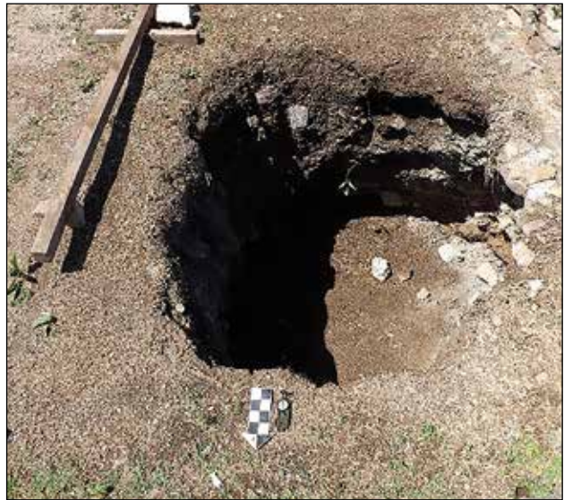
Socavón del Edificio A, una de las principales afectaciones, en la imagen tenía un diámetro de 1.80 metros / Foto: Archivo Técnico Proyecto de Conservación de los Edificios Dañados por los Sismos de 2017 en Monte Albán-Atzompa.
