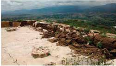
Afectaciones muro lado oeste del templo, Edificio 4.
