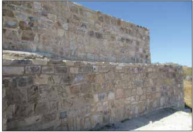
Fachada oriente del Edificio 16. Estado de la fachada después de los trabajos / Foto: Archivo Técnico Proyecto de Conservación de los Edificios Dañados por los Sismos de 2017 en Monte Albán-Atzompa.
