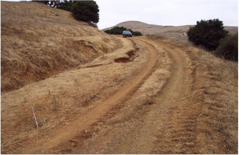
CALZADA CON SURCOS Y BARRANCOS, ANTES DEL TRATAMIENTO
