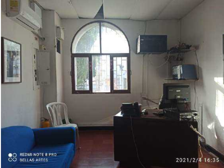
F-132. Alteraciones en muros por instalaciones técnicas sobrepuestas. Los paneles del cielo raso se encuentran sueltos. Se evidencia desprendimiento de material de acabado de muros.
