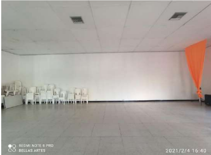
F-152. Se evidencian manchas de humedad en paneles de cielo raso. El piso se encuentra deteriorado y alguna piezas de enchape presentan fracturas.
