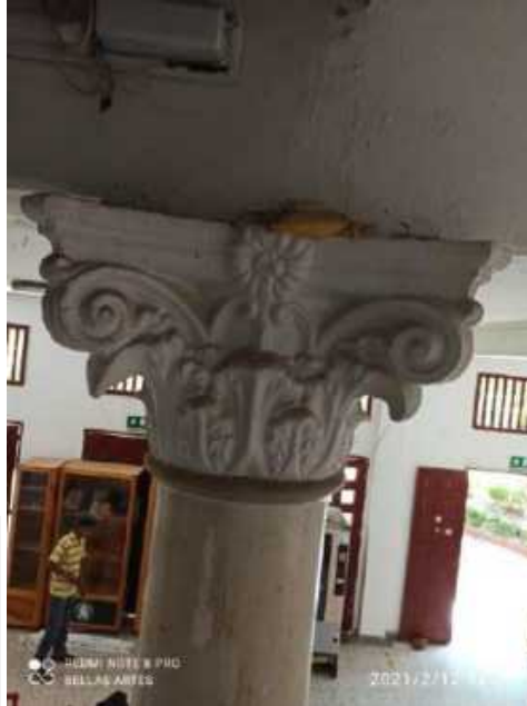
F-72. Se evidencian fisuras en la moldura y acumulación de suciedad sobre el capitel.
