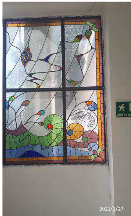
F-101. Se evidencian una dilatación entre la columna y el muro. Se observan fisuras y desprendimiento de material de acabado de vigas y muros. Los elementos metálicos que sostienen el mural se encuentran deteriorados y carecen de mantenimiento.
