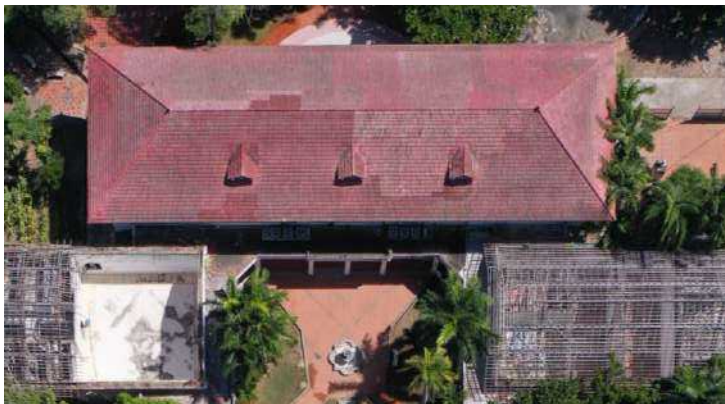
F-43. No se evidencian piezas faltantes, se presentan manchas de humedad y depósitos de excrementos de animales, bajo la cubierta de las buhardillas.
