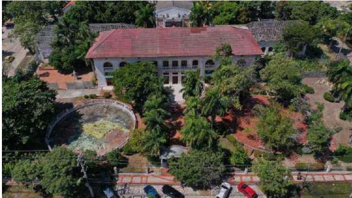
F-42. Cubierta a cuatro aguas con tejas de tipo marsellesa en cemento y armadura de madera, esta presenta deterioro por desgaste propio del material.
