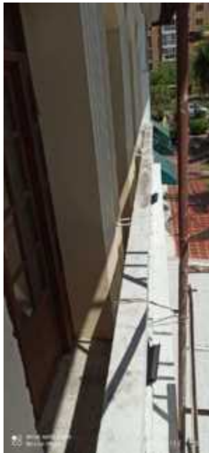
F-13. Se presenta deposito de partículas en la superficie exterior, lo que genera escurrideros sucios. Perdida de material superficial por efectos del viento y partículas.
