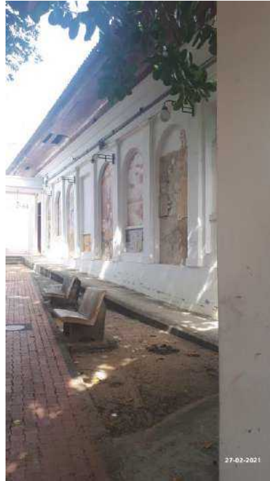
F-42. Los murales se encuentran afectados por las condiciones del ambiente y la falta de mantenimiento. Se presentan grietas en la escalera de acceso.
