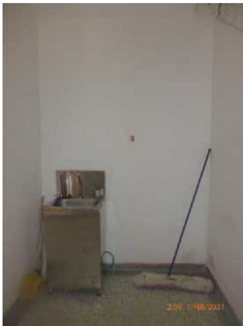
F-65. Se presentan manchas de humedad por capilaridad y fisuras en muros.
