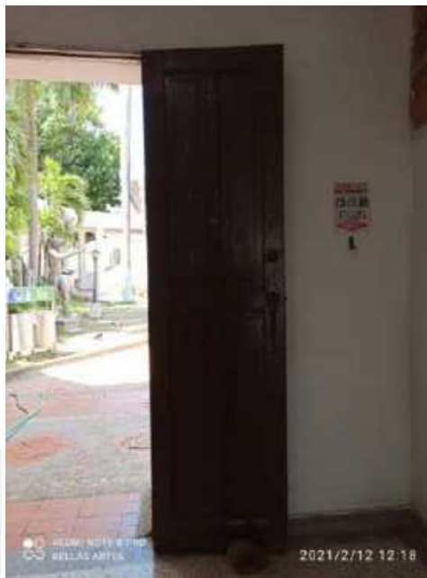
F-73. Se presenta deterioro en la carpintería en madera, fisuras en muros.
