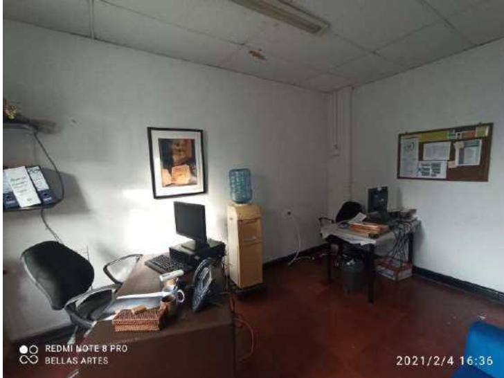
F-134. Se evidencian manchas de humedad en algunos paneles del cielo raso por posible filtraciones en la cubierta.
