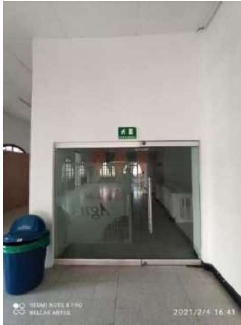
F-148. Las puertas en vidrio y sus herrajes se encuentran en buen estado. Se evidencias fisuras en material de acabado de muros.
