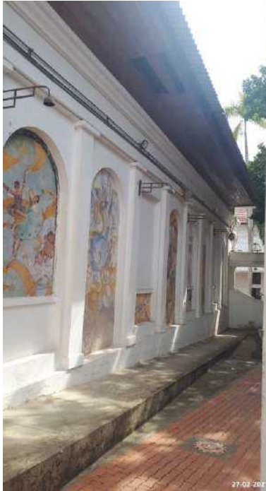
F-41. Se observa desprendimiento de acabado en algunas zonas. El machimbre se encuentra en regular estado y se presenta desprendimiento en zonas puntuales. Presencia de humedad capilar ascendente.
