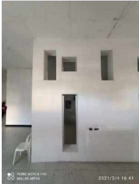
F-146. Se evidencian manchas de humedad en paneles del cielo raso por posibles filtraciones a través de la cubierta. Se presenta deterioro en material de acabado de pisos.
