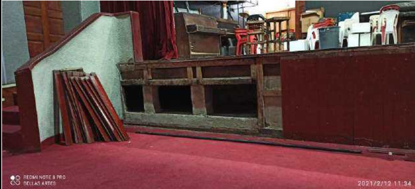
F-88. Se realizó inspección a la estructura de soporte del escenario y se evidencian manchas de humedad en las piezas en madera
