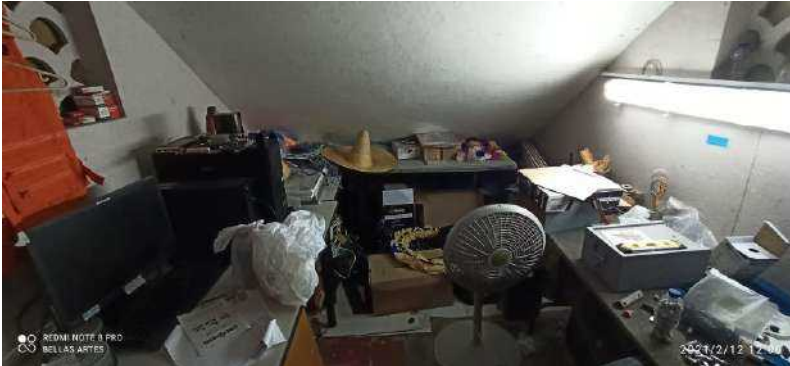
F-82. Se evidencia suciedad por acumulación de objetos. Desgaste de acabado de piso por rozamiento.
