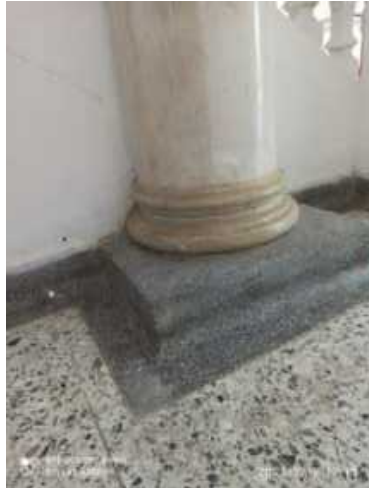
F-75. Se presenta humedad por capilaridad y fisuras en material de acabado de muros. Perdida de material de acabado de muros.
