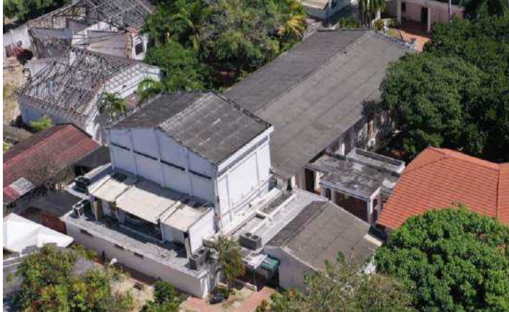
F-70. Se presenta deterioro por desgaste propio del material, falta de mantenimiento y exposición a cambio bruscos de temperatura de los elementos conformantes de las cubiertas a dos aguas.
