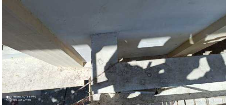
F-12. Se presentan manchas de moho debido a la humedad en barandas, por exposición de los elementos a la intemperie y falta de mantenimiento.
