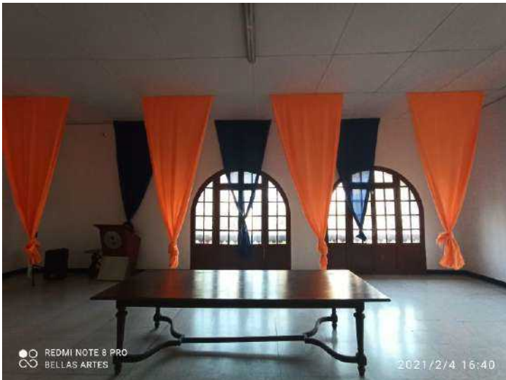
F-151. La carpintería en madera se encuentra deteriorada, se evidencian fisuras en material de acabado de muros.
