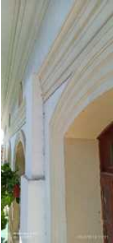
F-16. Se evidencia depósitos de partículas en suspensión sobre la superficie exterior lo que ha generado ennegrecimiento en algunas zonas de la fachada. Se presentan fisuras en acabados de muros.
