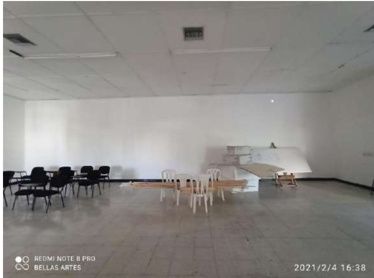
F-142. Se evidencia desgaste en material de acabado de pisos. Algunas piezas del enchape de pisos se encuentran fracturadas.
