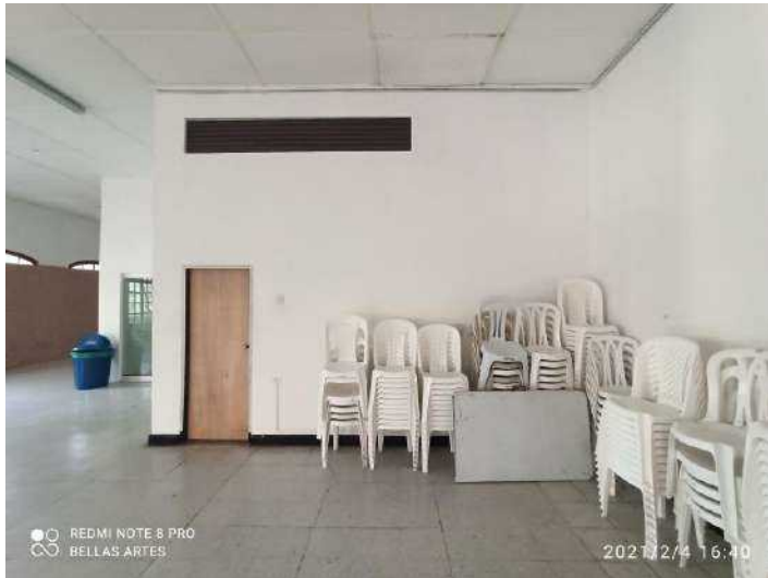
F-153. Se evidencias fisuras en material de acabado de muros y deterioro de cielo raso. Desgaste de material de acabado de pisos.
