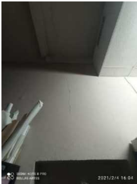
F-90. Se evidencian fisuras en material de acabado de muros y cableado sobrepuesto.
