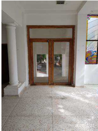
F-98. Se evidencia manchas y desgaste de materiales de pisos. La carpintería en madera se encuentra deteriorada. Se evidencian fisuras en los muros.
