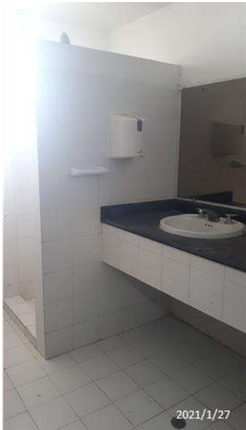
F-113. Falta de mantenimiento, fisuras en muros. Suciedad y manchas en los enchapes y elementos en porcelana. Deterioro en la carpintería de madera.
