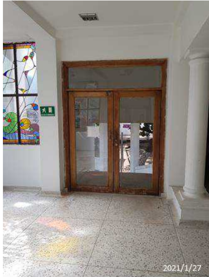
F-100. Se evidencia manchas y desgaste de materiales de pisos. La carpintería en madera se encuentra deteriorada. Se evidencian fisuras en los muros.
