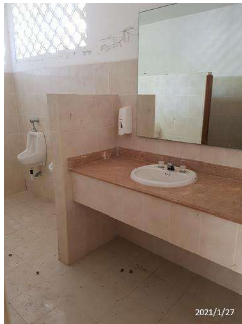
F-93. Se evidencia humedad y desprendimiento de material de acabado de los muros que dan hacia el exterior del inmueble. Manchas y suciedad en enchapes de muros y pisos y porcelanas sanitarias.
