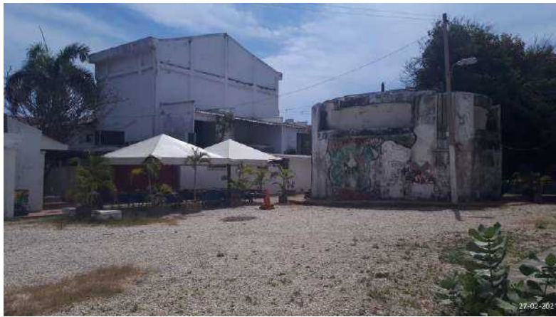
F-63. Se observa un volumen alto que corresponde a la tramoya del escenario y un segundo volumen mas bajo que corresponde a los camerinos, sobre los que se ubican los aires acondicionados. Por falta de mantenimiento, rebose de tubería y condiciones ambientales se presentan humedades, hongos y plantas. En esta fachada se evidencian volúmenes adosados a la concepción original.
