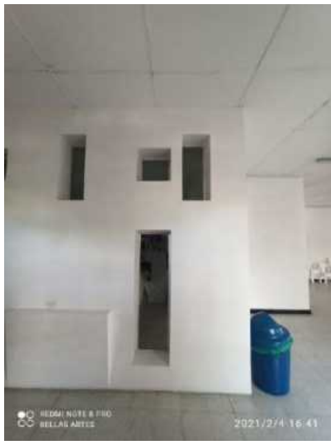
F-147. Se presentan fisuras y manchas de suciedad en la superficie de los muros.
