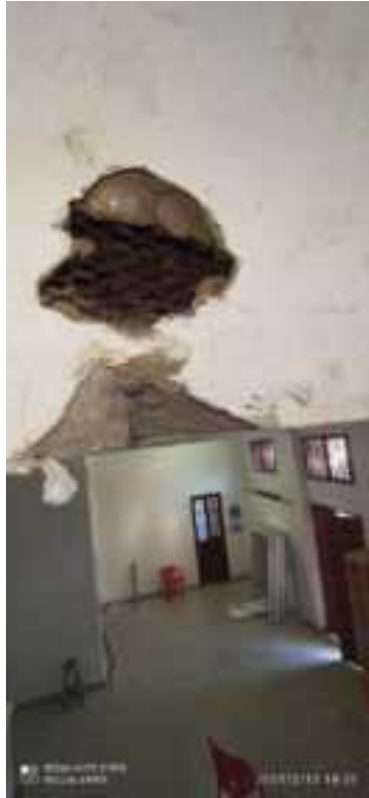
F-74. Se evidencia perdida de material de recubrimiento y oxidación en la malla eslabonada.
