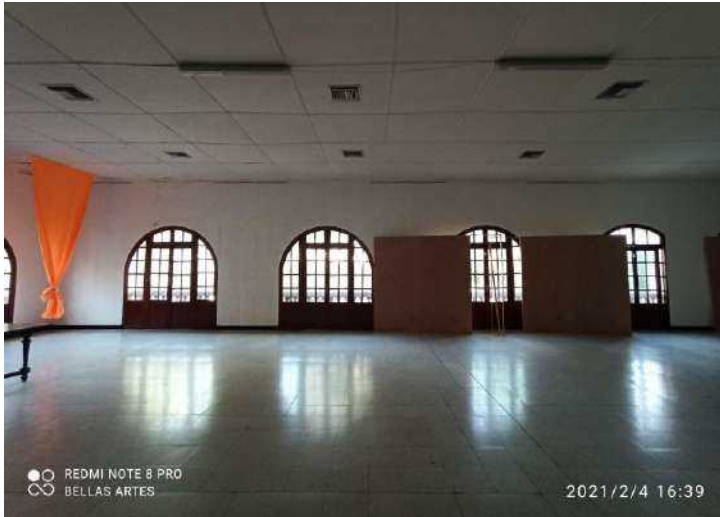
F-150. Se evidencian fisuras en material de recubrimiento de muros. Se presenta deterior en material de acabado de pisos y alguna de la piezas se encuentran fracturadas.
