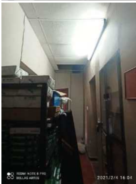
F-91. Se evidencia suciedad por acumulación de elementos. Pandeo en paneles que conforman el cielo raso.
