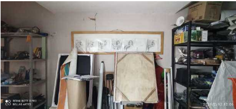
F-83. Se evidencian grietas en muro localizado debajo del descanso de la escalera. Suciedad por acumulación de elementos y falta de mantenimiento periódico.
