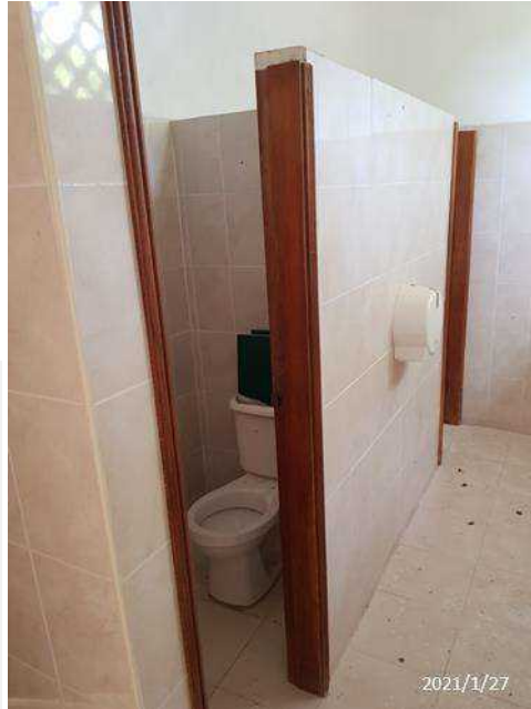
F-92. Se presentan fisuras en muros. Manchas y suciedad en enchapes de muchos, desgaste en enchape de pisos. La carpintería de madera se encuentra deteriorada. Falta de mantenimiento.
