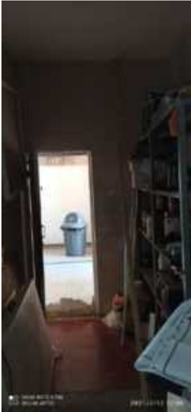
F-80. Se evidencia suciedad por acumulación de objetos. Desgaste de acabado de piso por rozamiento.
