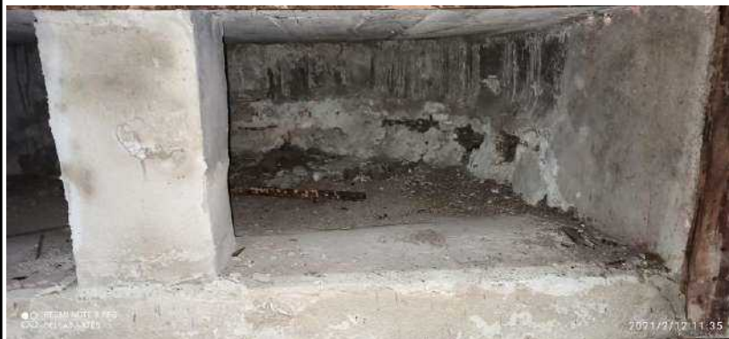
F-89. Así mismo se evidencia humedad por capilaridad en la estructura en concreto de escenario.
