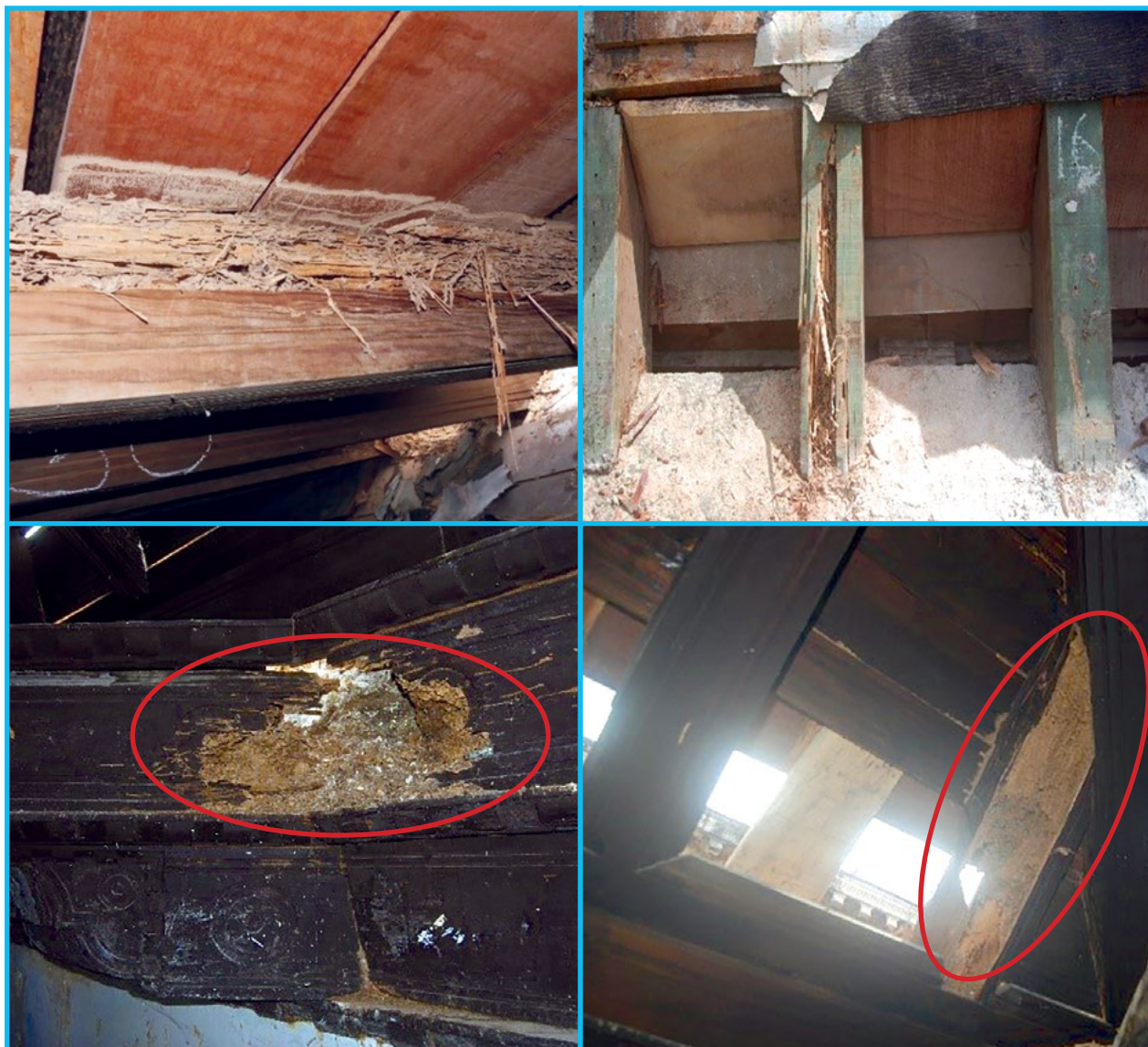
Fig. 32, 33, 34, 35: Desfibramiento producto del ataque de termitas subterráneas. Convento de Santa Clara de Asís
