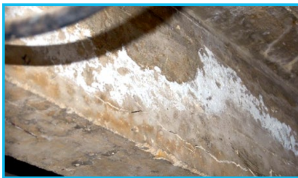
Fig. 111: Combinación de fenómenos de lixiviación, eflorescencia y agrietamiento longitudinal por corrosión de los aceros de refuerzo, en viga de hormigón armado. Colegio Universitario San Gerónimo de La Habana, Edificio Santo Domingo
