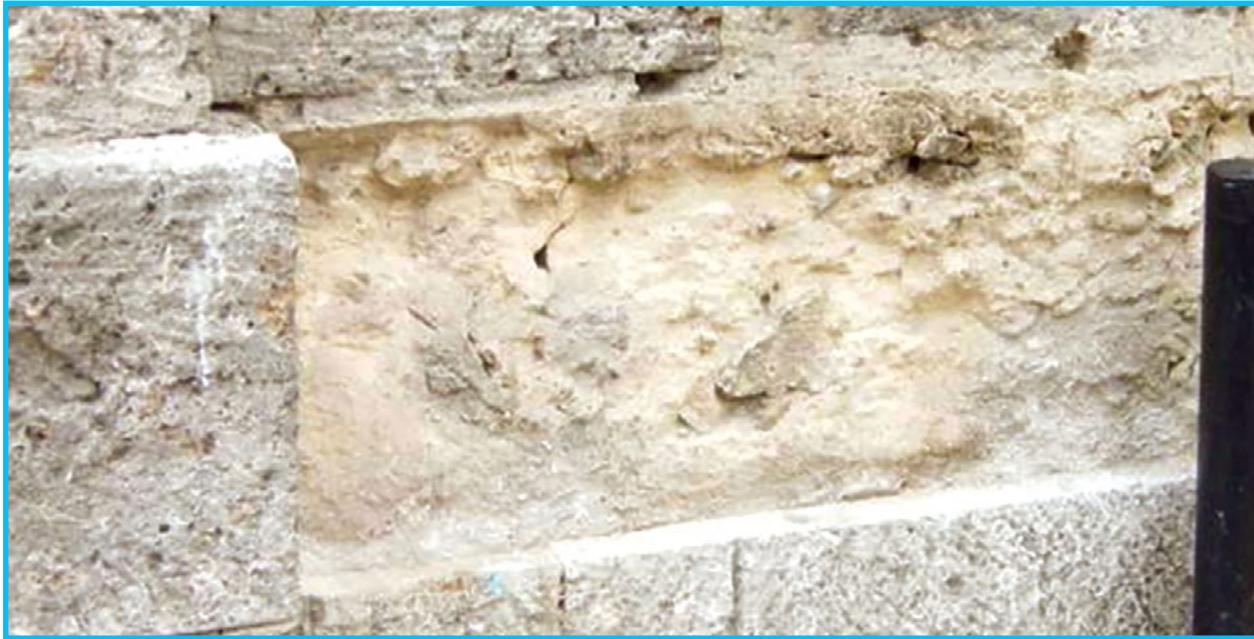
Fig. 64: Desintegración granular del bloque de piedra. Convento San Francisco de Asís
