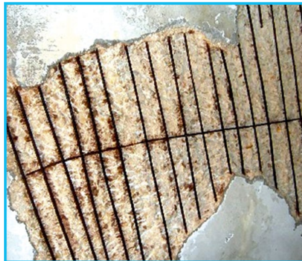
Fig. 115: Macrocelda de corrosión por presencia de cloruros en la masa de hormigón. Capitolio Nacional
