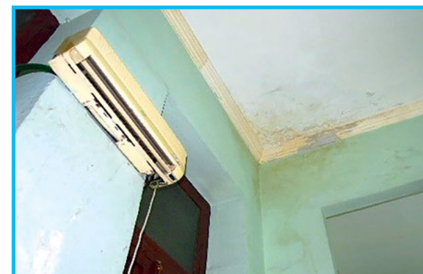
Fig. 73: Humedad por condensación en el techo y muro. Clínica estomatológica de La Habana Vieja
