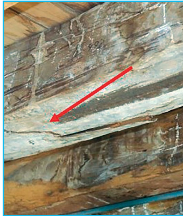
Fig. 42: Grieta transversal en viga. Despacho Público, Palacio de los Capitanes Generales
