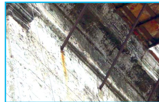
Fig. 91: Pátina naranja por corrosión de soportes de hierro adheridos a los muros
