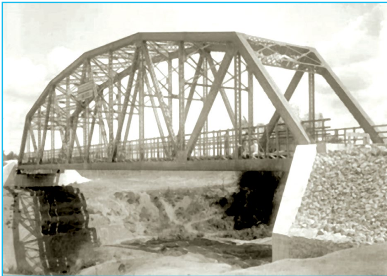
Fig. 119: Vista del puente de Jatibonico al concluir la construcción de la Carretera Central, en marzo de 1931. Fuente: Centro de Documentación Arq. Fernando Salinas, Restaura, OHCH
