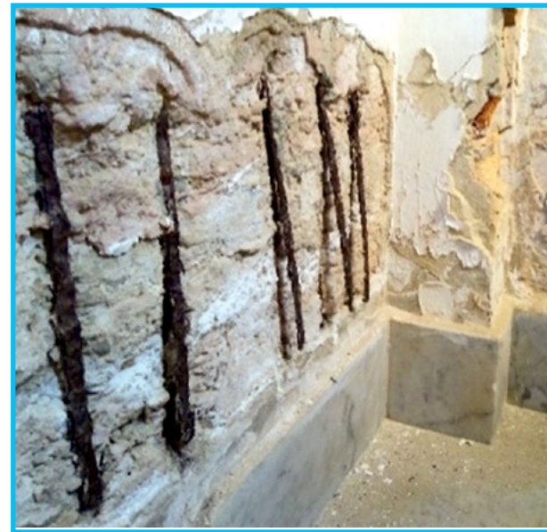
Fig. 107: Columna de ladrillo por el lado del foso del Castillo, afectada por pérdida de recubrimiento
