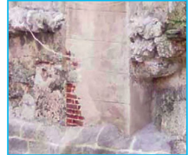
Fig. 88: Columna de ladrillo por el lado del foso del Castillo, afectada por pérdida de recubrimiento
