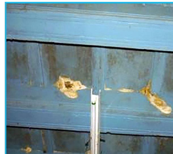
Fig. 28: Hongos de pudrición blanca. Palacio de los Condes de Jaruco
