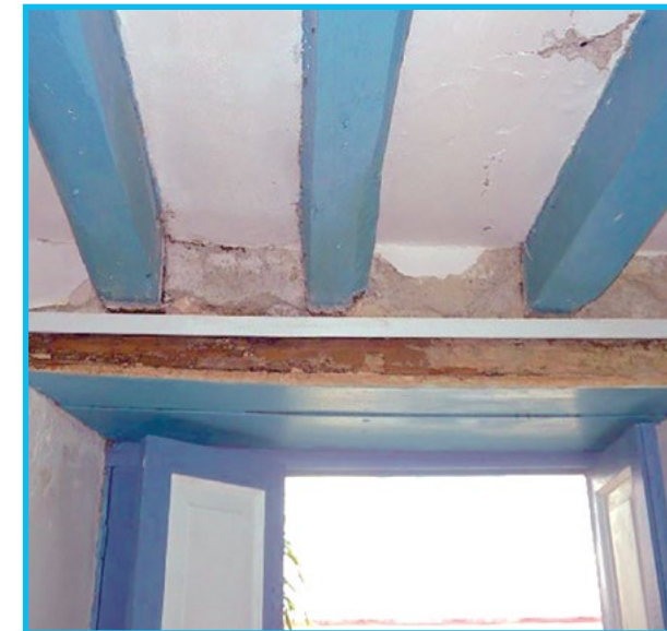
Fig. 1: Dintel de madera. Obra: Aula del museo Simón Bolívar
