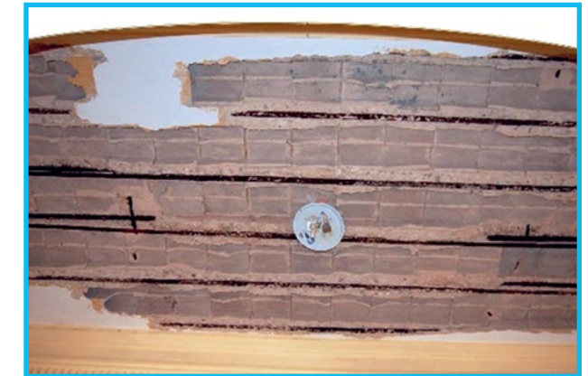
Fig. 109: Pérdida del recubrimiento y aceros de refuerzo expuestos por corrosión en el sistema de vigueta y bovedilla. Casa de la Asociación de Combatientes
