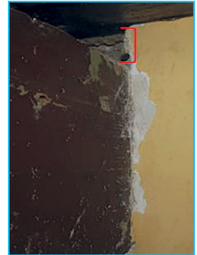
Fig. 38: Desplazamiento en viga con descenso de 6,0 cm. Restaurante La Mina
