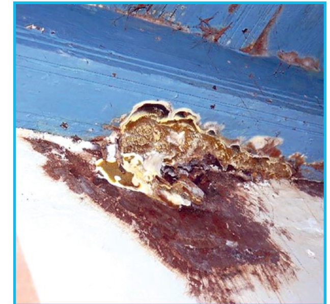
Fig. 27: Hongos de pudrición blanca. Palacio de los Condes de Jaruco
