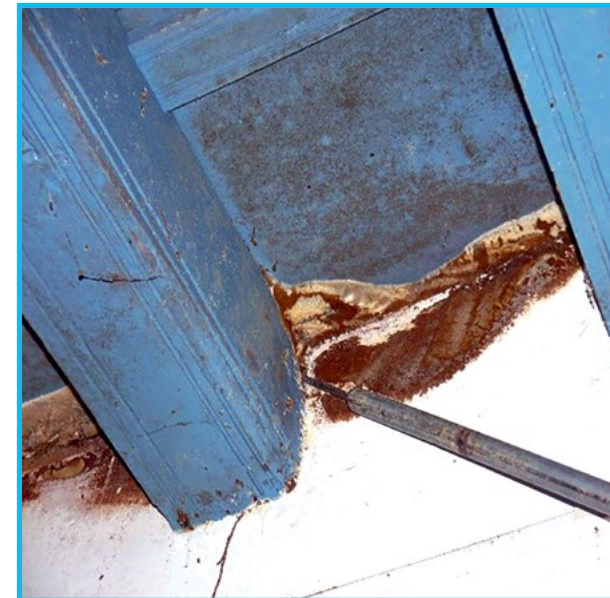
Fig. 26: Hongos de pudrición parda. Palacio de los Condes de Jaruco
