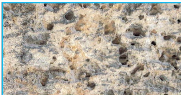
Fig. 65: Alveolización en muro de fachada Palacio del Segundo Cabo
