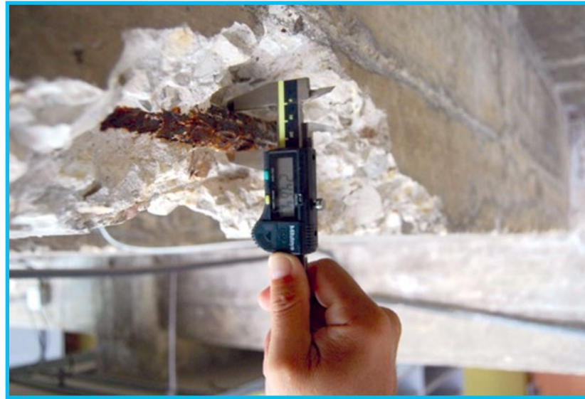
Fig. 133: Ensayo de medición de pérdida de sección con pie de rey digital. Cátedra de la Lengua Española. Edificio Santo Domingo
