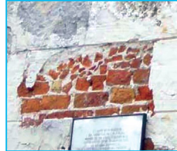
Fig. 87: Ladrillo expuesto y erosionado en fachada
