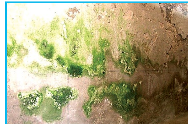
Fig. 71: Humedad por capilaridad con eflorescencias y biopelículas de coloración verde. Convento San Francisco de Asís
