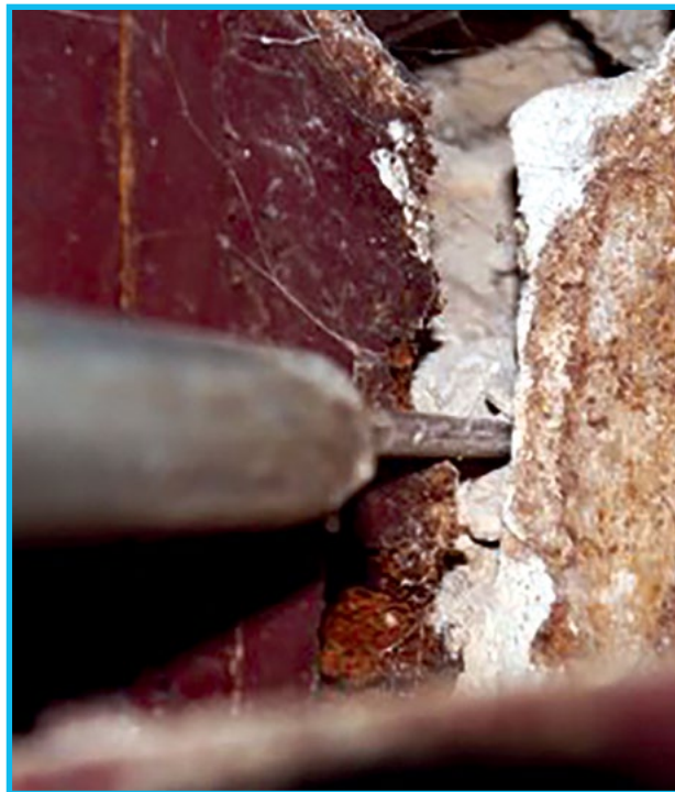
Fig. 43: Pérdida de material en cabezal. Restaurant La Mina
