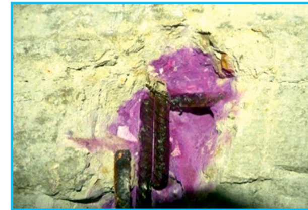
Fig. 109: Acero corroído por los efectos del avance del frente de carbonatación. Viga de hormigón armado. Convento de Santa Clara de Asís
