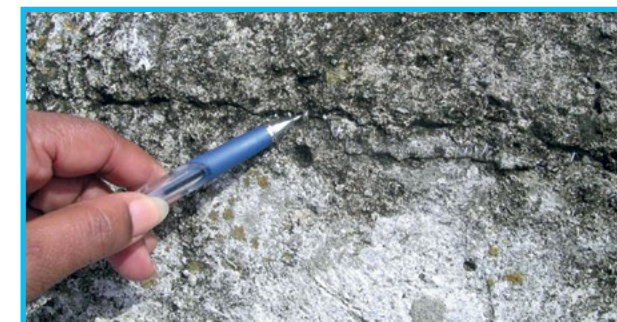
Fig. 62: Grieta en muro exterior de piedra. Convento San Francisco de Asís
