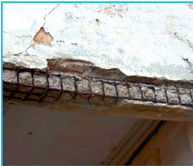
Fig. 114: Corrosión inducida por cloruros en viga de hormigón armado. Edificio de viviendas. Malecón No. 67
