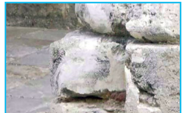
Fig. 92: Ausencia de material en el rejuntado y fractura de la piedra
