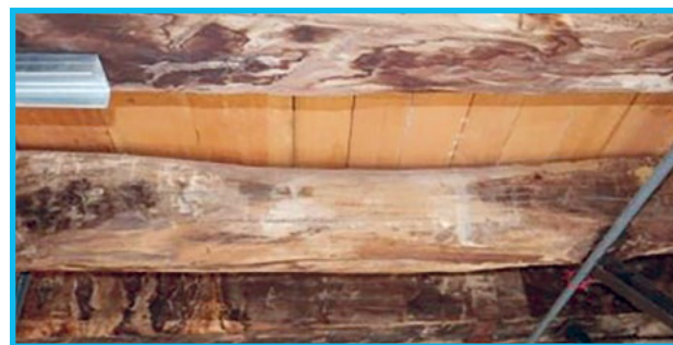
Fig. 24: Cambio de coloración en el forjado. Despacho Público, Palacio de los Capitanes Generales
