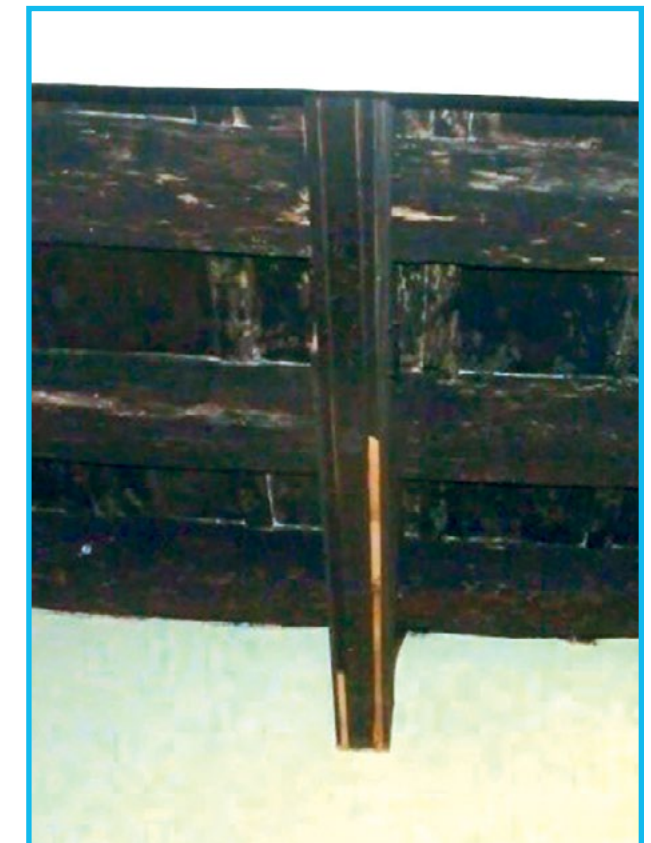
Fig. 40: Flechas en vigas. Restaurante La Mina
