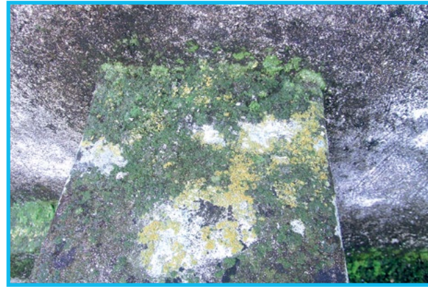
Fig. 70: Colonización biológica en muros de cubierta. Convento San Francisco de Asís
