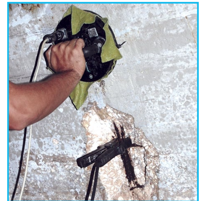
Fig. 138: Medición de velocidad de corrosión ( I_{corr} ) con GECOR 8. Capitolio Nacional
