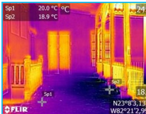
Fig. 17: Medición termográfica en galería de circulación del Convento de Santa Clara de Asís
