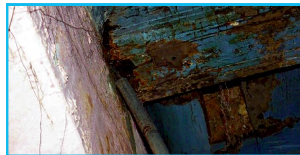
Fig. 25: Hongos de pudrición parda. Palacio de los Condes de Jaruco
