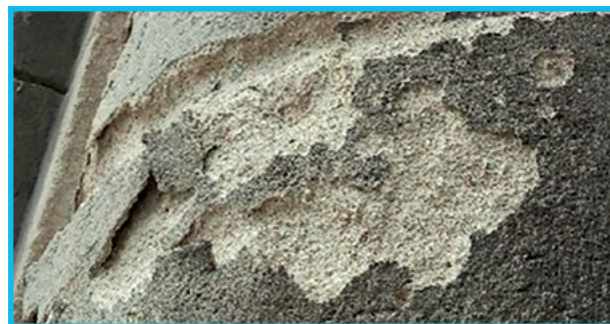
Fig. 66: Erosión en columna. Plaza de La Catedral
