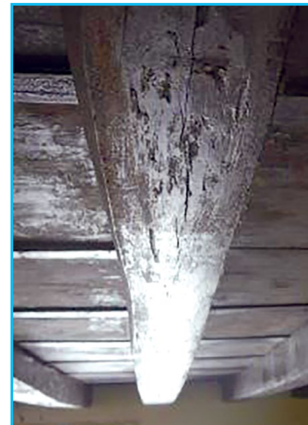
Fig. 39: Flechas en vigas. Restaurante La Mina
