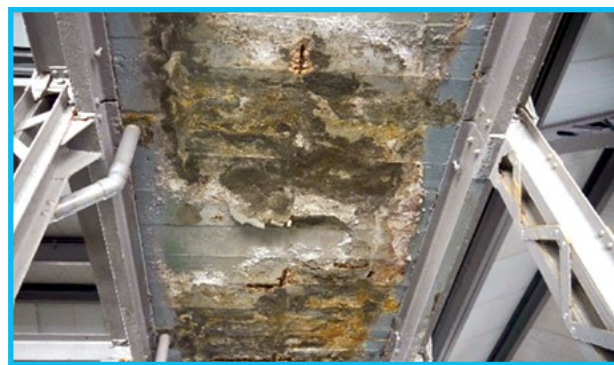
Fig. 112: Afectación general en losa de hormigón armado por infiltración de agua pluvial. Almacenes San José
