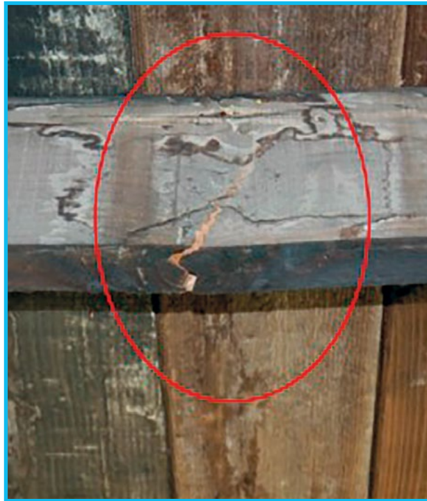
Fig. 41: Grieta transversal en correa. Empresa Tabacuba
