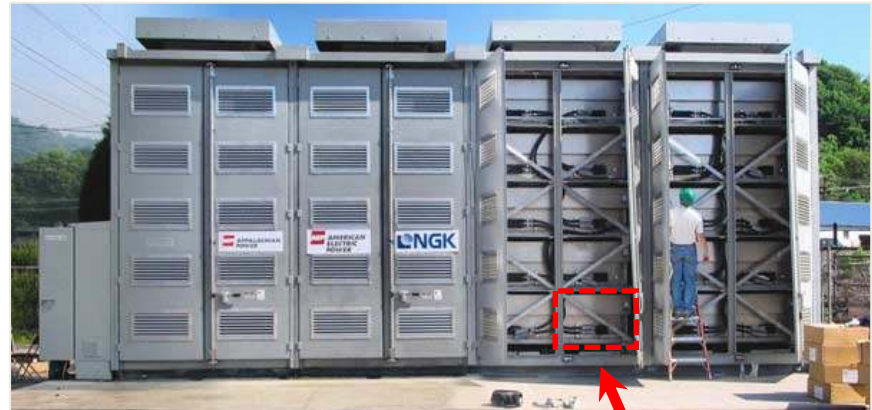
4 MWh / 2 MW 80 x 50 kWh (NaNiCl)
