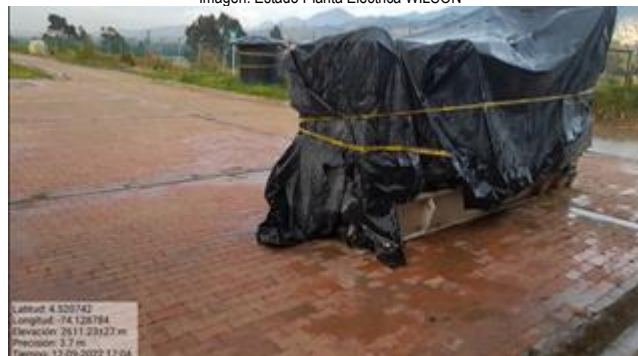
Imagen. Estado Planta Eléctrica WILSON
