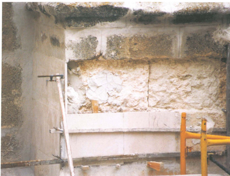
FIGURA 7. Chapado de Piedra Natural de sillares deteriorados.
