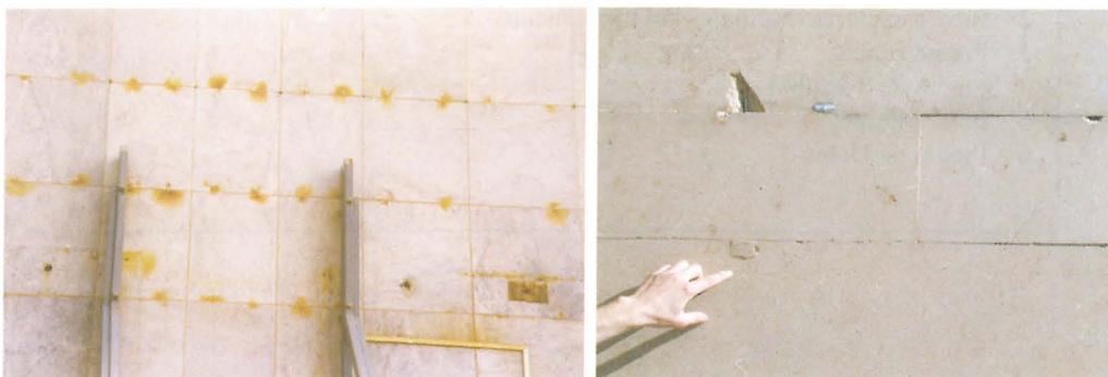
FIGURA 12. Daños en placas de Piedra Natural por el tipo de anclaje utilizados.
