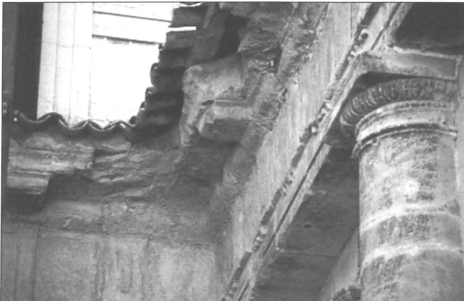
FIGURA 1. Deterioro de la piedra en la cornisa del claustro de la Catedral de Cuenca.
