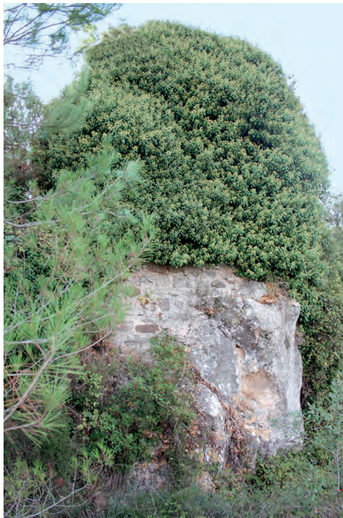
Restos de la torre cubiertos por la vegetación
