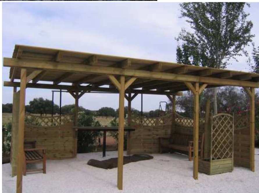
Foto 44: Pérgola anclada directamente en el suelo. Clase de riesgo 4.1
