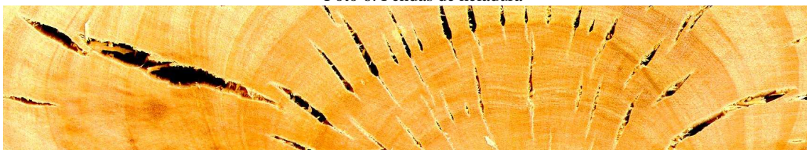
Foto 6: Fendas de heladura
