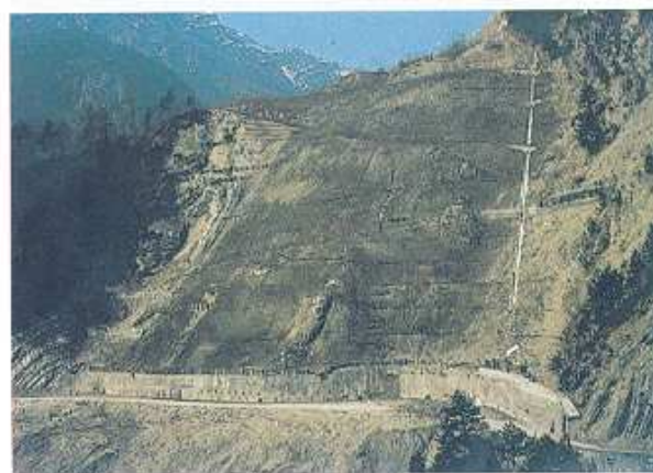
Esempio di sistemazione e consolidamento di un vecchio movimento franoso di grandi dimensioni: si notano graticciate vive di ontano bianco, opere miste a cassero in legname e pietrame, muri di pietrame a secco entro gabbioni metallici, muro di sostegno al piede e palizzata paramassi in legname.
