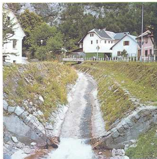
Sistemazione a cunetta di tipo tradizionale, realizzata mediante la selciatura del fondo e il rivestimento delle sponde con grossi blocchi di pietrame calcareo, in corrispondenza dell'attraversamento dell'abitato di Ugovizza (Rio Uqua - Comune di Malborghetto).
