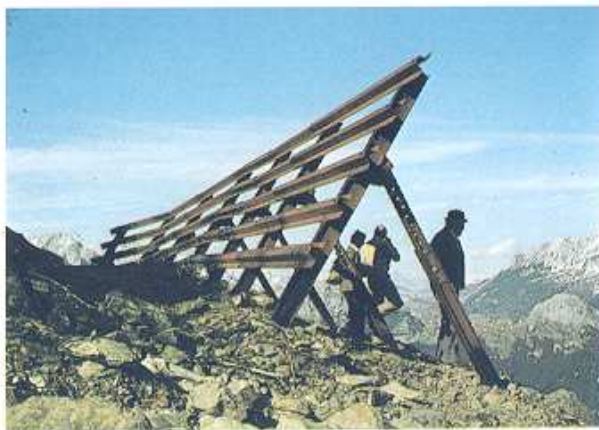
Filare di opere antivalanga, realizzato con ponti da neve in elementi prefabbricati d'acciaio, ubicato nella zona superiore di distacco della valanga di Cleulis (M. Zoufplan - Comune di Paluzza).
