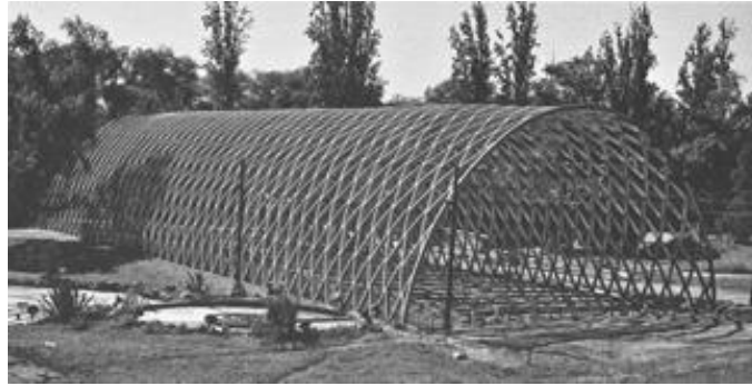
Imagen 156. Pabellón de la República de Chile 1953. Moreno. Estructura parabólica en construcción Fuente: AAVV (2012)
