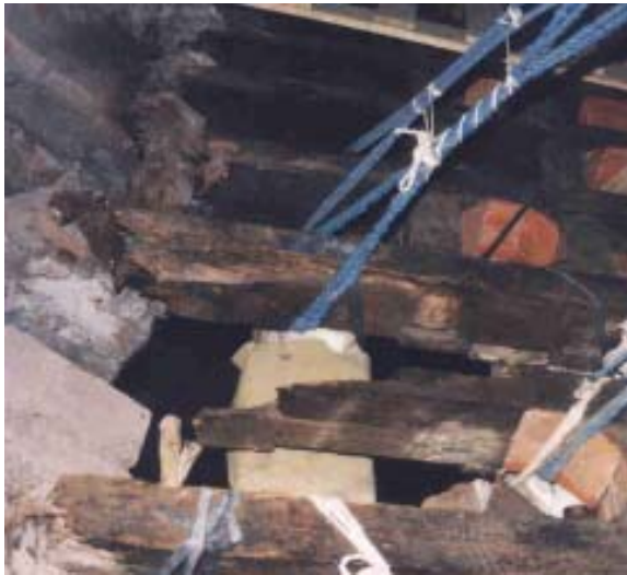
Deterioro de pies de pares.
