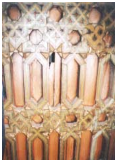
Estado de deterioros en lacerías y tablas de forro.
