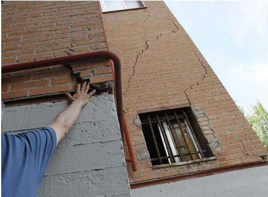
Ejemplo de estructura con fisuras. (Imagen obtenida de 20m, enlace en imagen)
