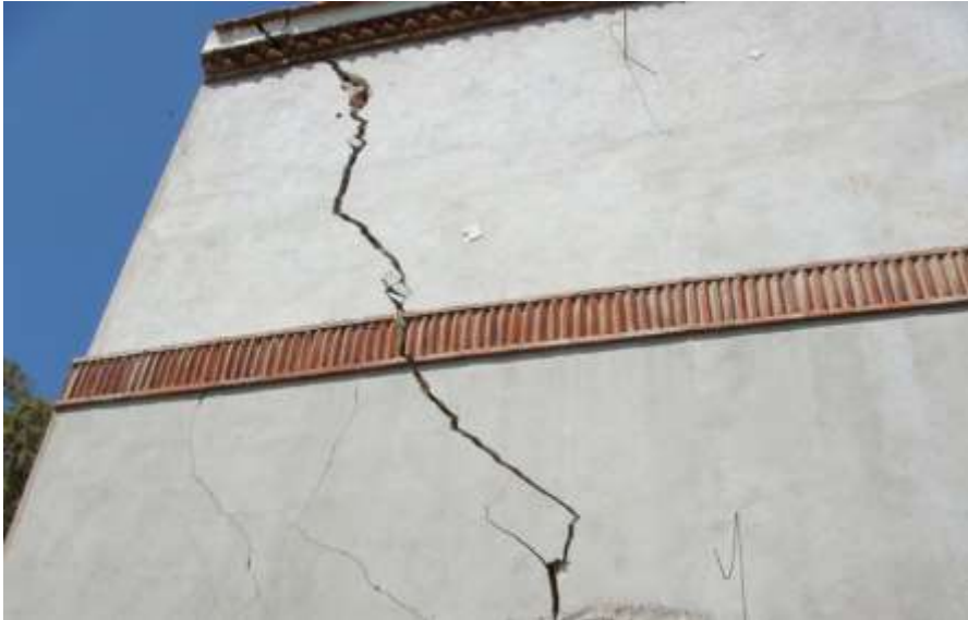
Ejemplo de agrietamiento por asentamiento. (Imagen obtenida de www.rosaverde.com , enlace en imagen)
