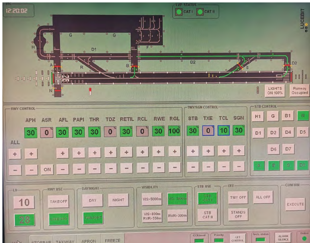
Fot. 4. Pulpit sterowania oświetleniem nawigacyjnym na wieży TWR Autor: B. Marciniak, Port Lotniczy Poznań-Ławica
