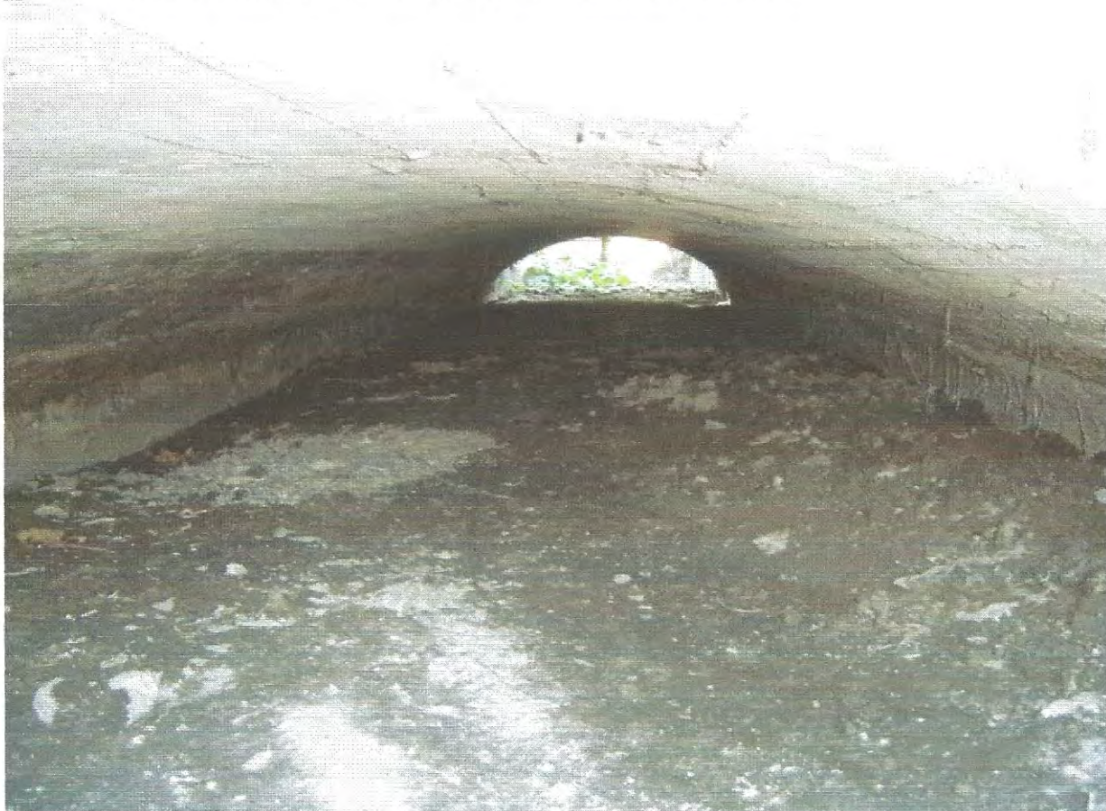
33.- Secció PK – 024 Riera d'en Burgada. Obra de pas sota GE 682 – omplerta d'arrossegaments.
