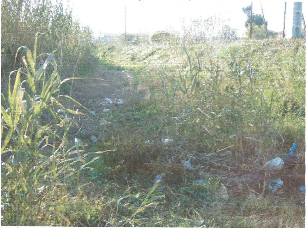
31.- Secció PK – 071 Riera d'en Burgada, la llera. Aigües avall de l'obra de pas sota la nova carretera, i abans de la obra de pas de la carretera a Blanes GE-682.
