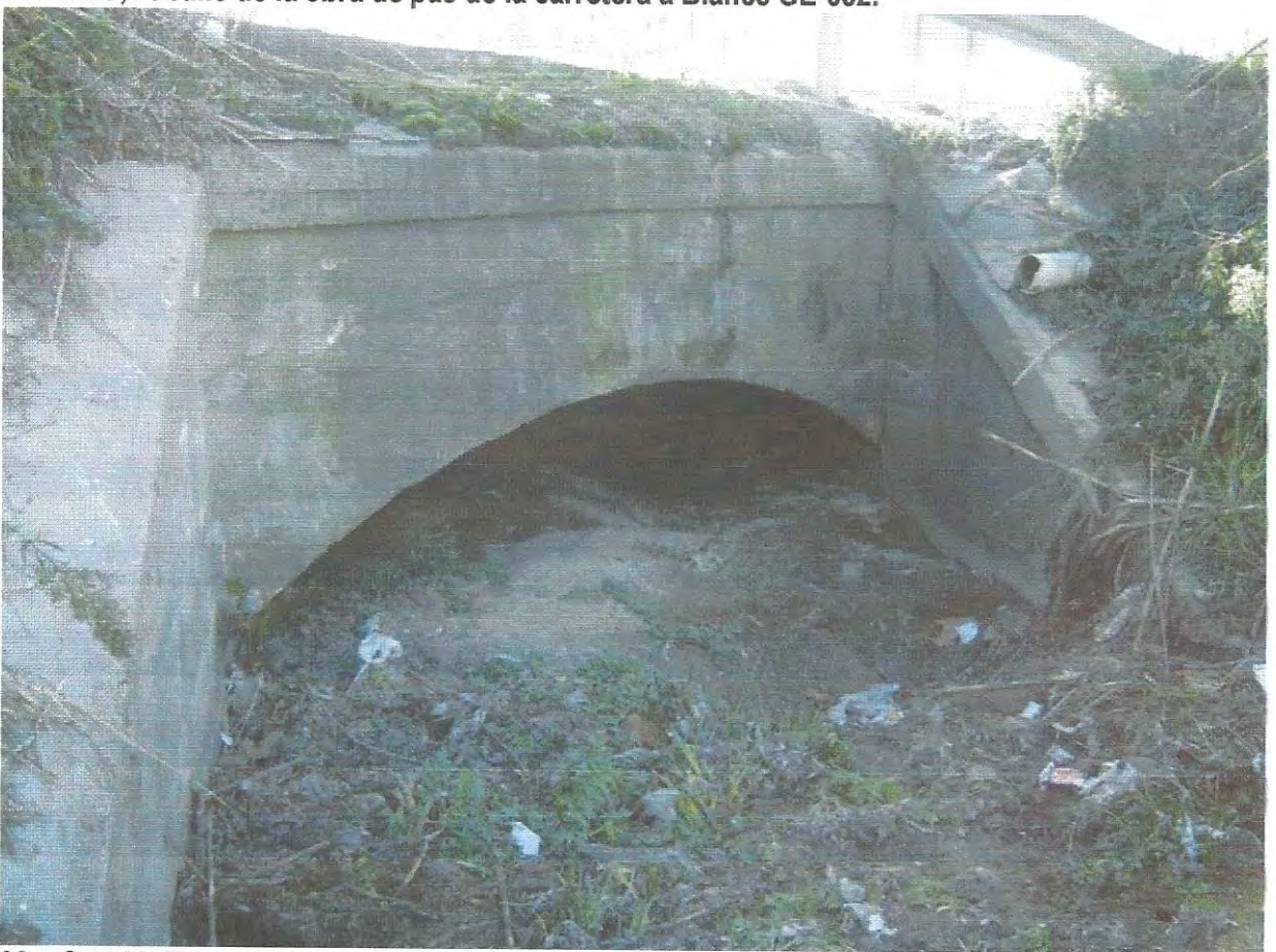
32.- Secció PK – 033 Riera d'en Burgada. Obra de pas sota GE 682 – omplerta d'arrossegaments.
