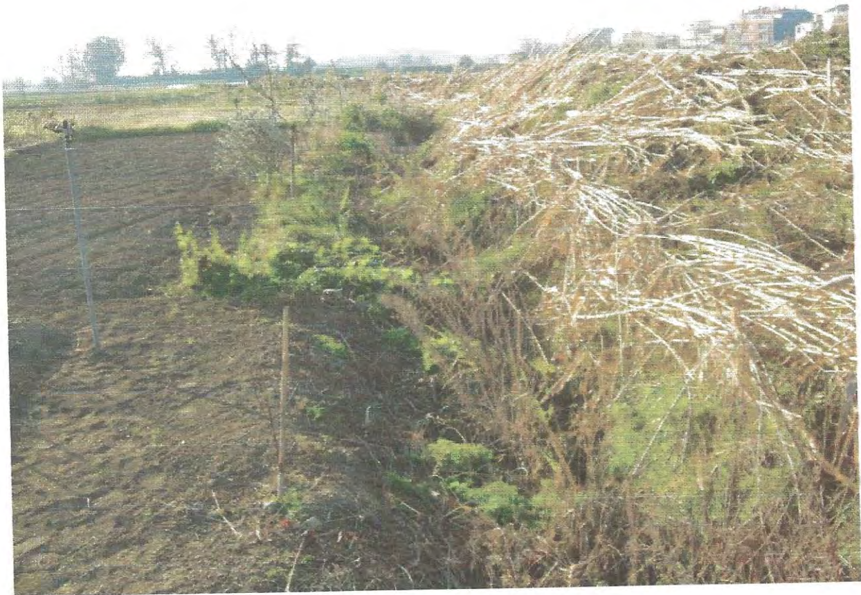
1.- Secció PK -745 Rec del Molí. La llera – vista general cap a aigües avall.
