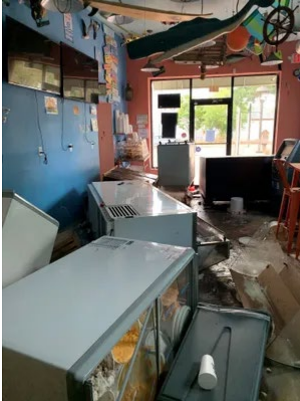
Fig. 19: Estragos de la inundación en la heladería Summer Ville Ice Cream Shop en Somerville, Nueva Jersey.
