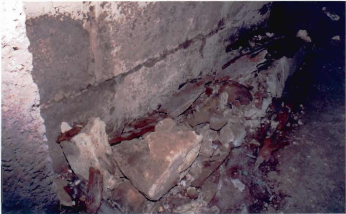
Enterramiento del lateral izquierdo (Fotografía 2)
