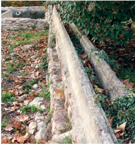
Figura 2. Aspecte actual (desembre de 2015) de la mina de Can Cruz a l'alçada de la bassa de Can Jornet Xic. Foto: J. Bertran
