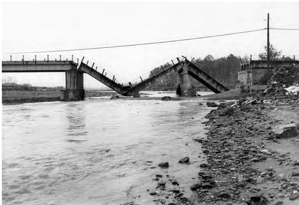
Figura 6. La riuada del 21 de setembre de 1971 va trencar la cinquena pilastra del pont del Besòs a la banda de Martorelles i va provocar la caiguda de dos dels seus trams, fet que el va deixar definitivament inutilitzat. Foto: Arxiu Històric Municipal de Mollet del Vallès
