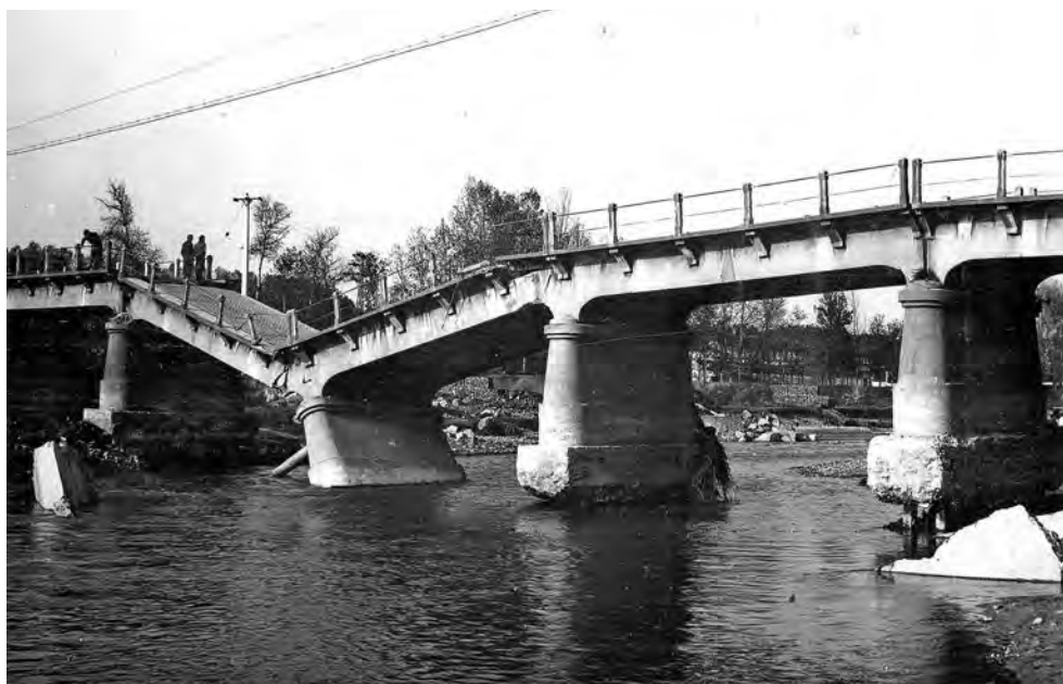
Figura 4. El 15 d'octubre de 1965 la riuada va enfonsar el pont sobre el riu Besòs. Foto: O. López
