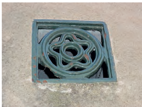
Figura 4. Detall de la ceràmica de ventilació de la caseta de cloració, amb l'estrella de 5 puntes maçònica. Foto: A. Morera
