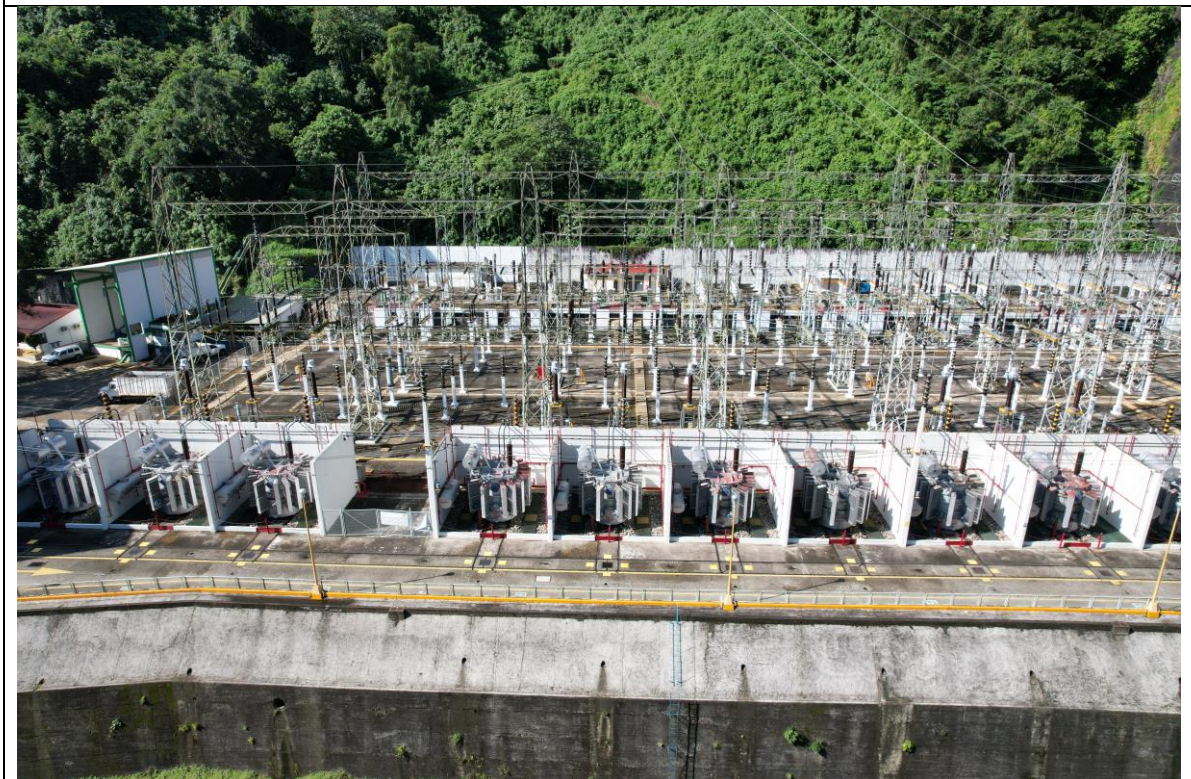
Foto 2. CH Mazatepec, Subestación Eléctrica
