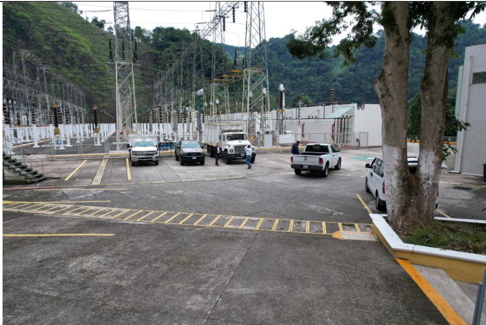
Foto 8. Aspecto al interior de la CH Mazatepec
