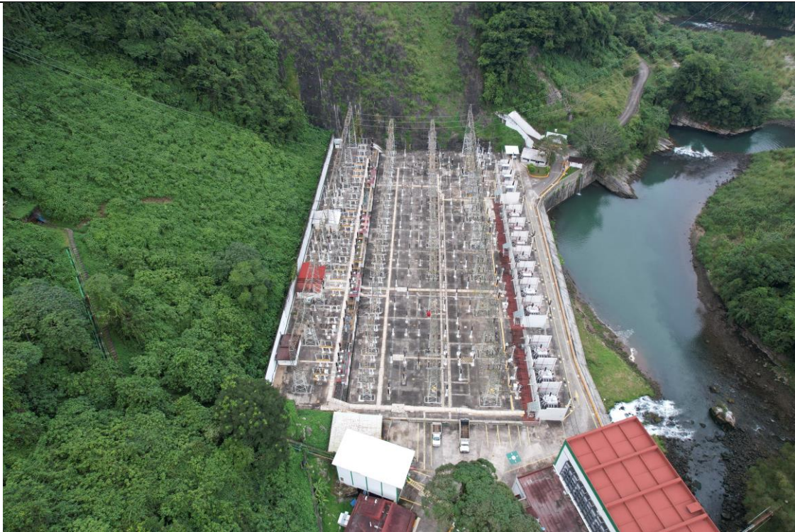
Foto 4. Subestación Eléctrica Mazatepec
