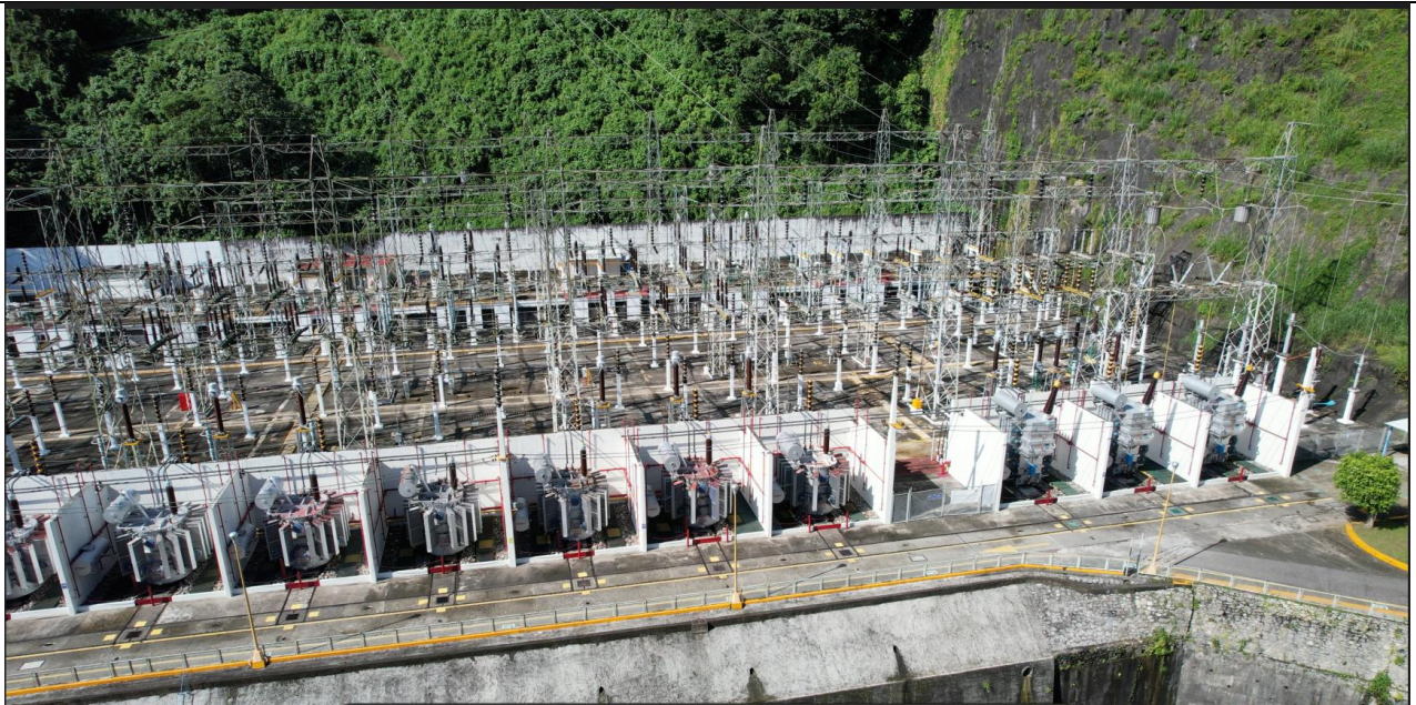
Foto 5. Se ilustra el arreglo de la ubicación de los transformadores a sustituir, las paredes que las resguardan no serán removidas.
