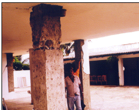
Daños estructurales. Pilar dañado
