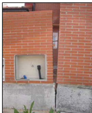
Grietas en un edificio
