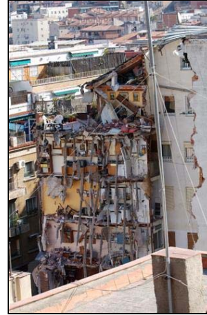
Edificios afectados por el derrumbe del metro en El Carmel
