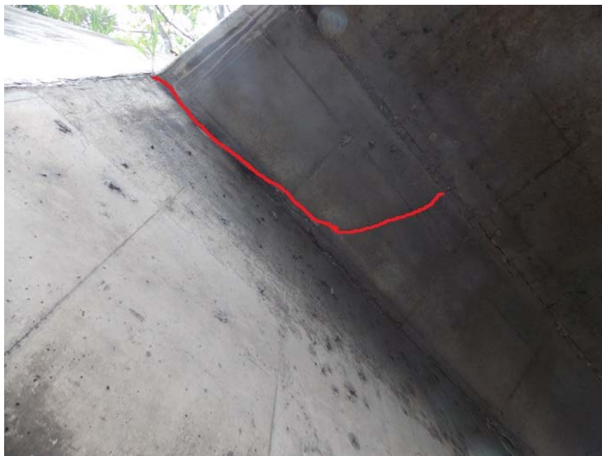
Figura 8: Grieta no estructural en el apoyo del bastión 2, costado oeste.
