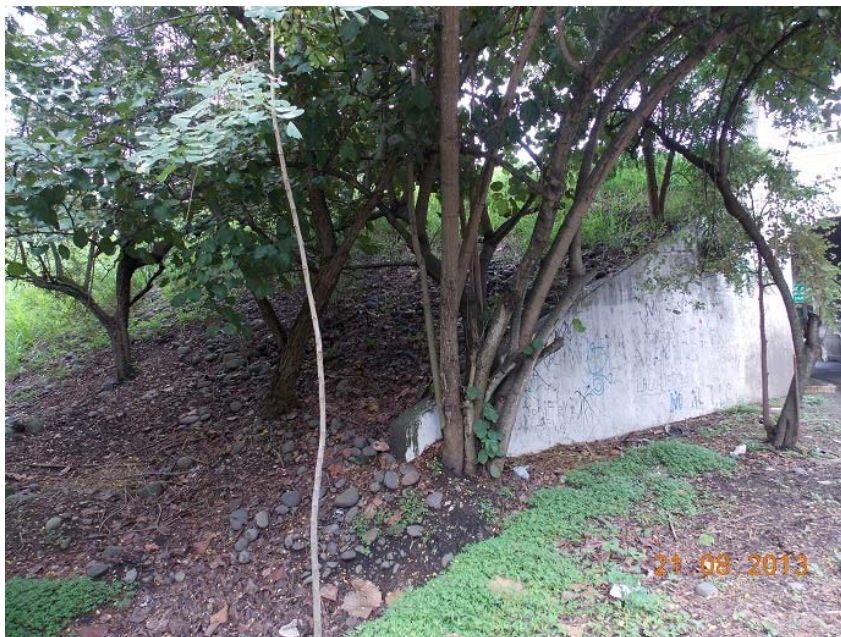
Figura 5: Talud lateral del acceso norte al costado oeste, no cuenta con un sistema de drenaje.
