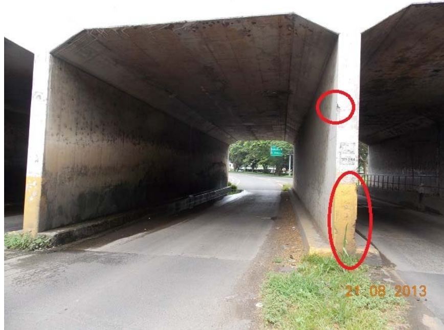
Figura 11: Desprendimiento de concreto en la pila 2 debido a impactos.
