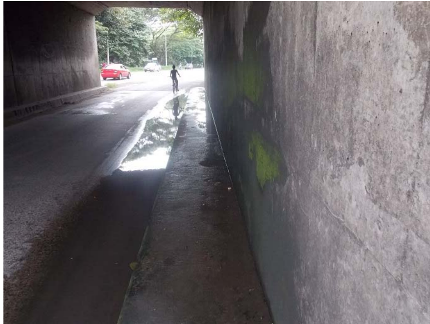
Figura 9: Humedad en el muro del bastión 1, debido a la salpicadura de agua de escorrentía acumulada en la calzada.
