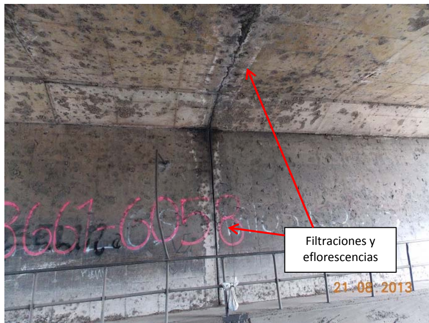
Figura 10: Filtración a través de junta vertical del muro del bastión 2. Nótese la presencia de eflorescencias tanto en el bastión como en la losa.
