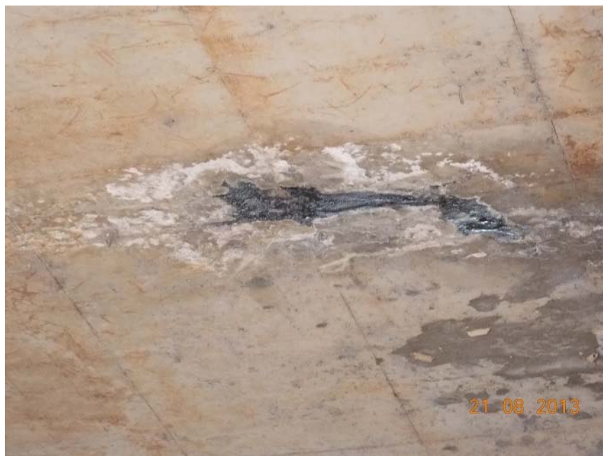
Figura 7: Eflorescencia en la cara inferior de la losa.
