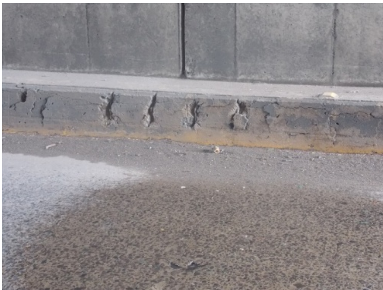
Figura 13: Desprendimiento de concreto en el bordillo de protección del muro de la pila 2, debido al aumento del volumen del refuerzo por corrosión.
