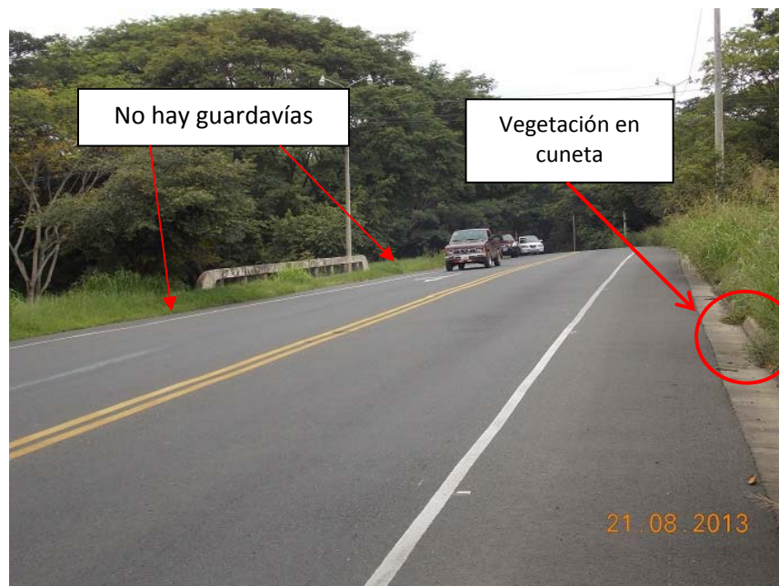
Figura 2: Faltante de guardavías en los accesos y junta cubierta con asfalto, visto desde el acceso norte.
