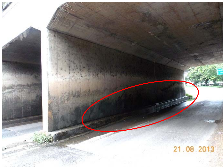
Figura 12: Acumulación de agua en la pila 1 que salpica sobre la pila por el tráfico vehicular.
