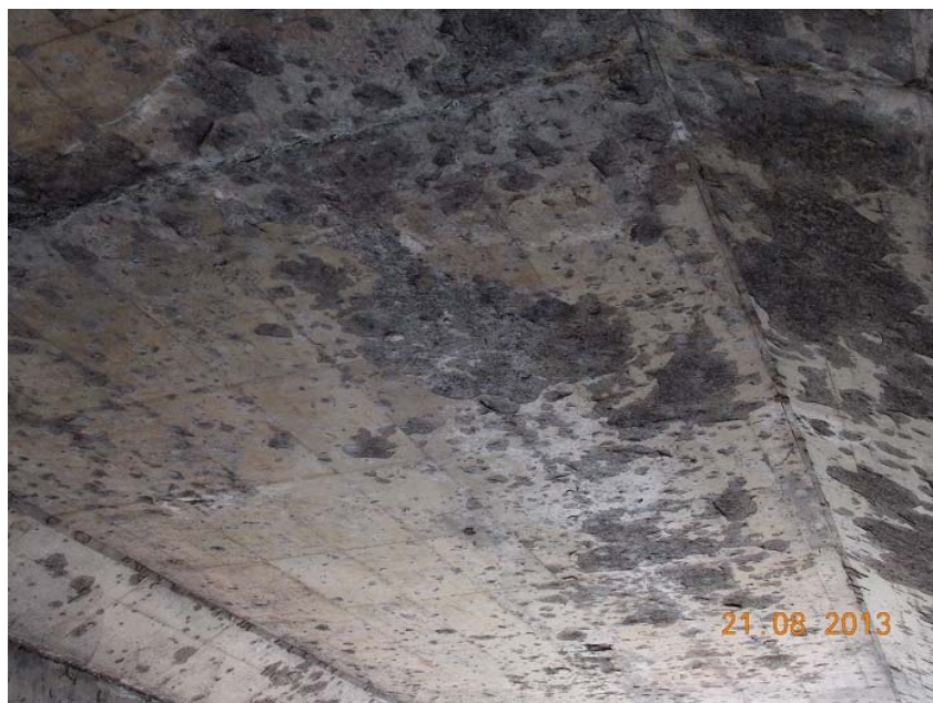
Figura 6: Deterioro del concreto en la cara inferior de la losa en tramo entre bastión 2 y pila 2 debido a filtraciones.
