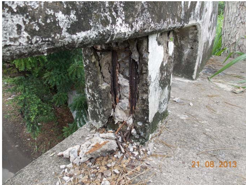
Figura 1: Pérdida de recubrimiento y corrosión severa del refuerzo en barrera vehicular costado este.
