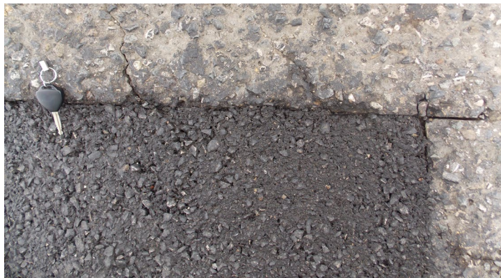
Figura 19. Corte realizado en el perímetro del bache que debería ser sellado para evitar la penetración de humedad dentro del bache.
