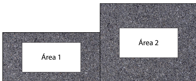
Figura 21. Bache de forma irregular.
