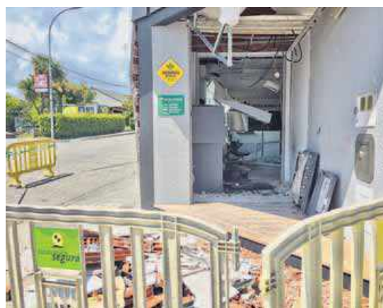
La puerta de la oficina quedó destruida por la explosión. ÓSCAR CELA
