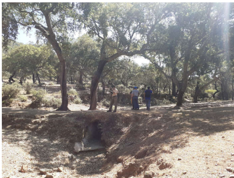
Foto 22: Tomada a la altura del punto P22 de las Operaciones Materiales (PS12), sobre un antiguo paso de agua
