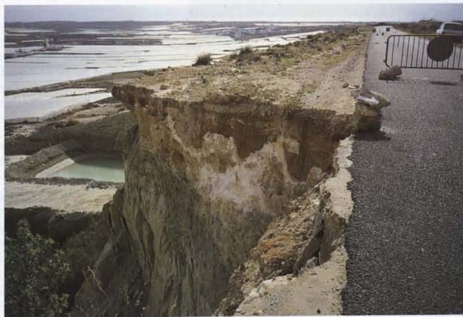
Fotografía 4. Erosión y desprendimientos por explotación y socavamiento en el escarpe
