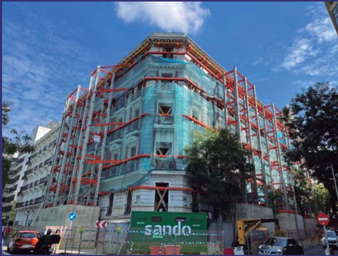
Estabilizadores de fachada
