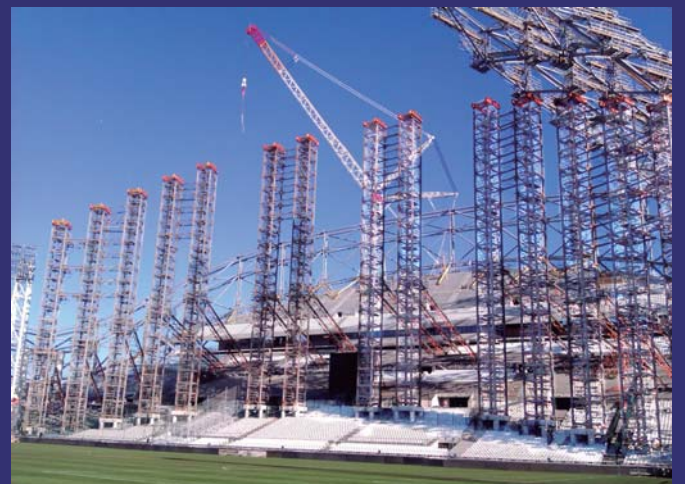
Torres de Alta Carga
