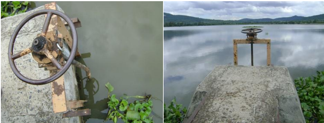
Figura 5.44 Compuerta de toma
