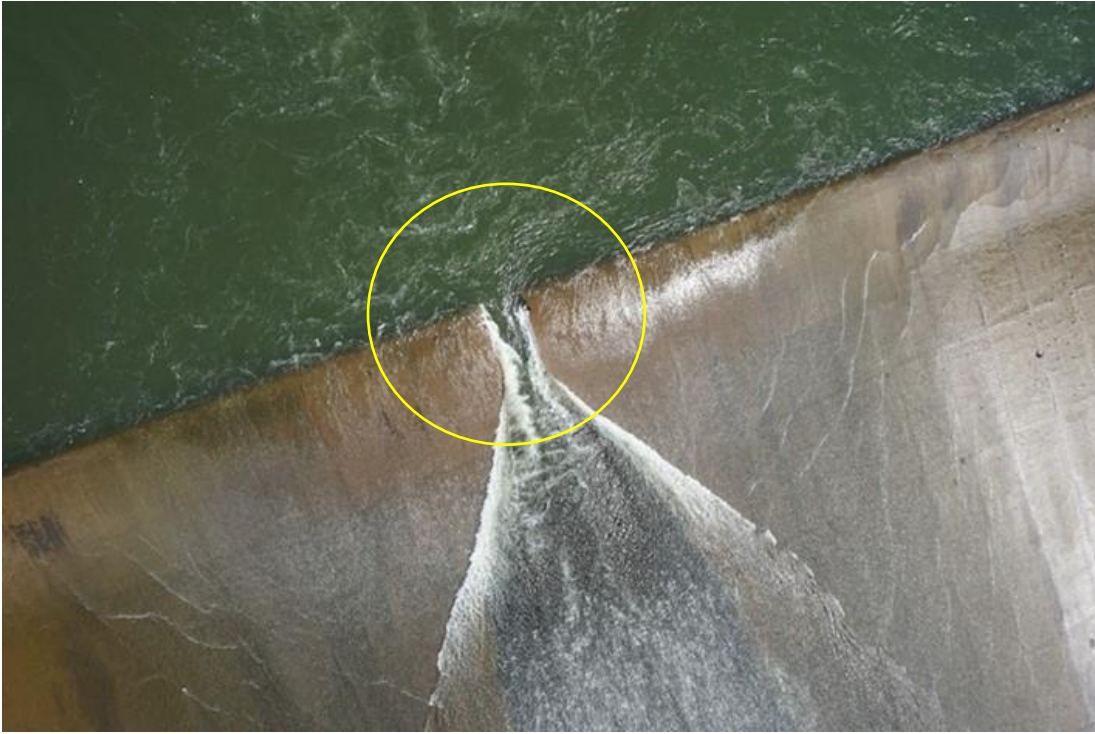
Figura 5.48 Detalle del desgaste del vertedor en la zona de convergencia de flujos
