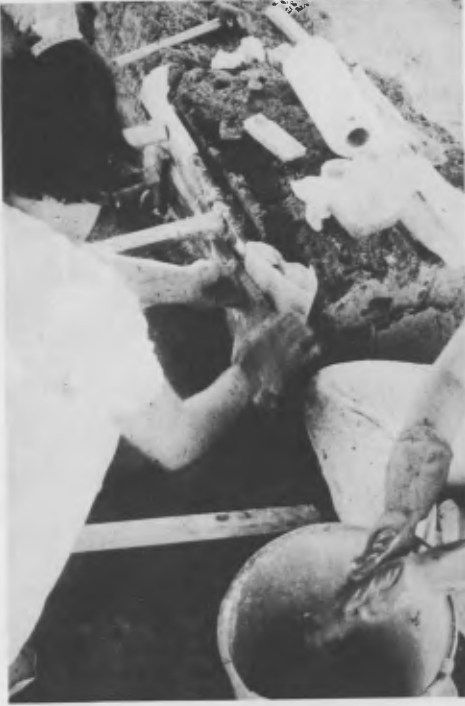
Figures 3-4: CIVITA MUSARNA (Viterbo, Italie), Calidarium; fixage préventif des fresques et protection in situ des parois en tuf avec argile expansée Leca.
