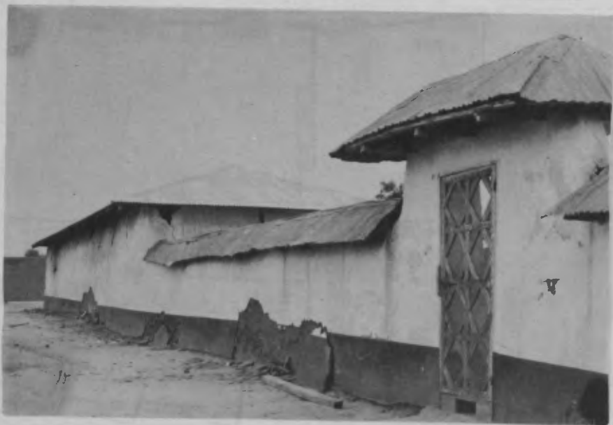
Maison des étrangers. Détachement de l'enduit à la base des murs. Perte du niveau original du sol de la cour.
