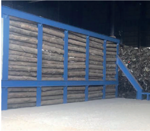
Fig. 25 Muro Berlín para contención de chatarra en los patios de Gerdau-Corsa (México)
