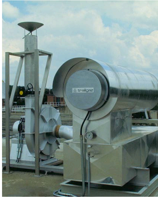
Destructor de ozono (sobre cámara de contacto)
