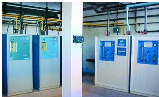
Cabinas para dosificación de cloro y dióxido de cloro
