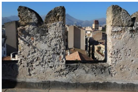
Fig. 5 - Superfici degradate dei merli.
