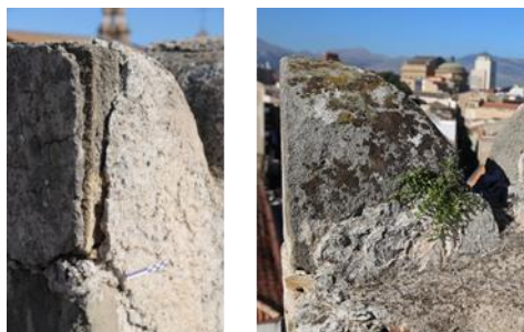
Fig. 7 - Intonaco distaccato e degrado biologico.
