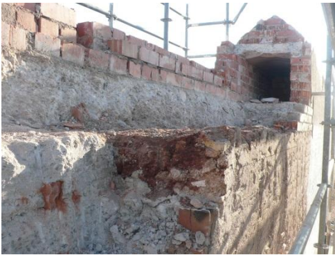
Fig.7.- Vista tomada en una de las fases constructivas de las actuales obras de restauración (2015), donde se aprecia el zuncho de hormigón armado de la desafortunada restauración acometida en los años 70.
