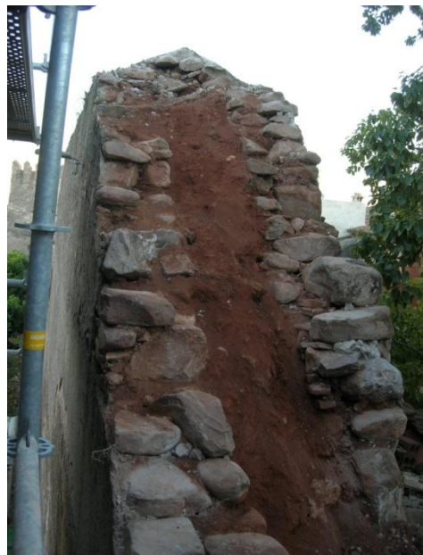
Fig. 4.- Sección de la tapia en la parte reconstruida en 1942 por Regiones Devastadas.
