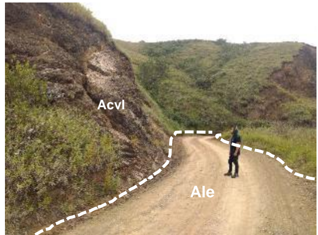
Foto 18 Corte vertical de ladera sobre roca intermedia de la Formación Volcánica Fuente: El Autor
