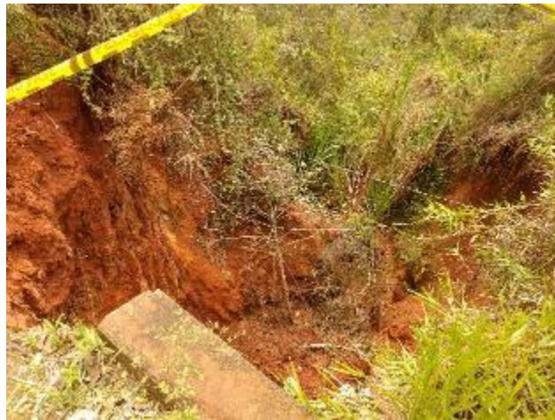
Foto 21 Aspecto general de la ladera en el sector donde ocurrió el movimiento N°1. Fuente: El Autor
