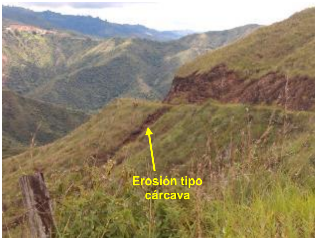
Foto 26 Procesos erosivos ocasionados por el descole de las alcantarillas Fuente: El Autor
