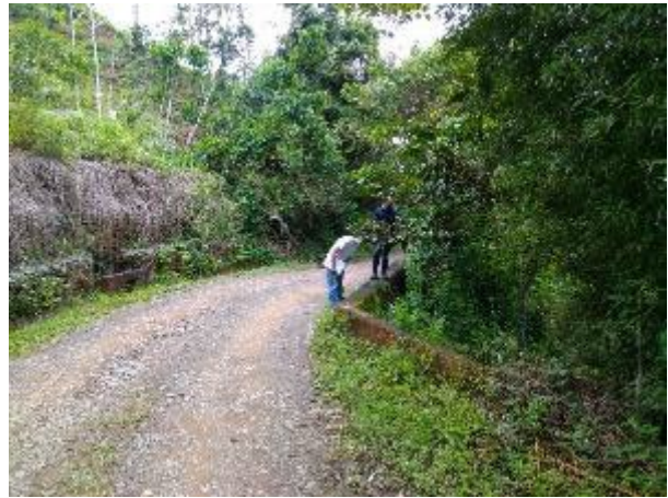
Foto 23 Aspecto general de la vía en el sector donde existe el movimiento en masa N°2. Fuente: El Autor
