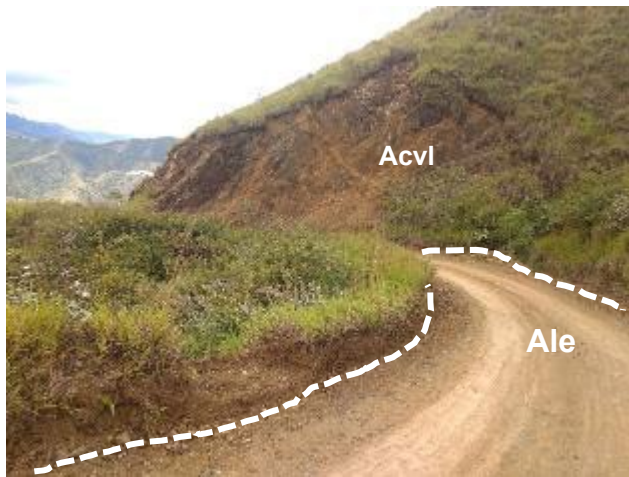
Foto 17 Corte vertical de ladera sobre roca blanda de la Formación Volcánica Fuente: El Autor
