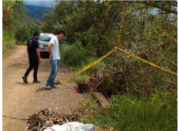
Foto 20 Aspecto general de la vía en el sector donde ocurrió el movimiento N°1 Fuente: El Autor
