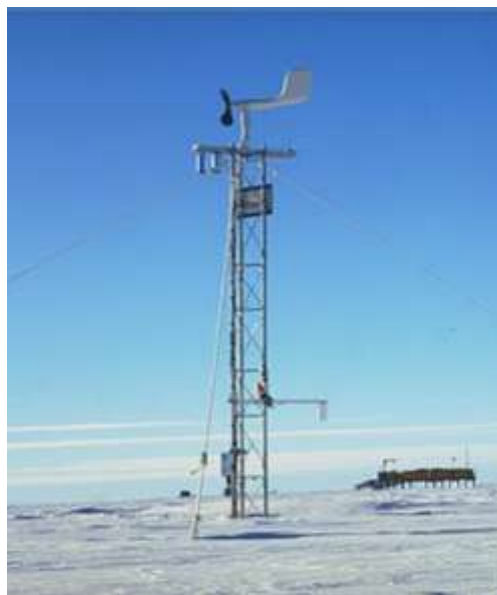
Fig. 3.4. Estación meteorológica automática. Equipada con un panel solar y archivos para las temperaturas, el vapor de agua, la dirección del viento y la presión del aire. Los datos son transferidos vía satélite. Otros equipamientos de medida en la estación proporcionan información sobre el tiempo local y para la aviación local. Fuente: AWI
