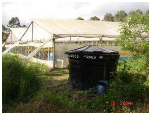
Figura 123. Tanque de reserva de agua
