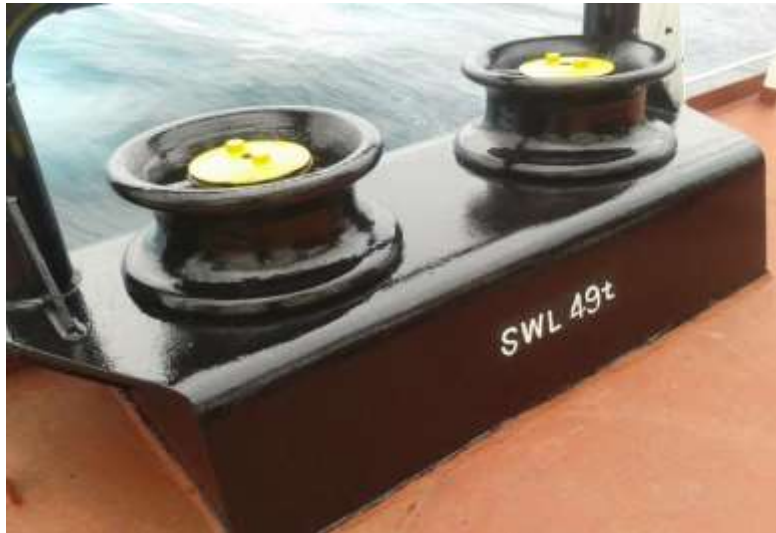
ROLETE: Con su eje dañado y tapado por falta de mantención
