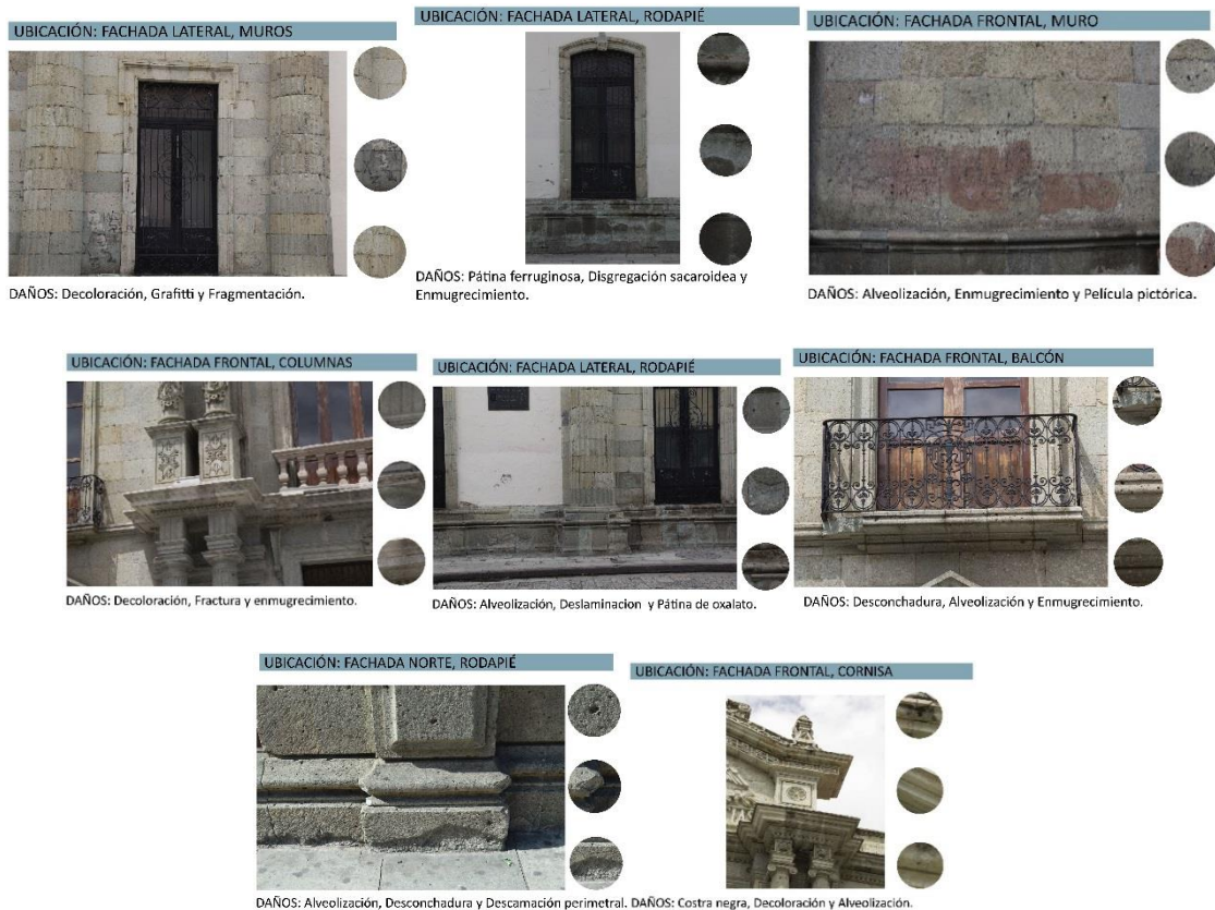
Figura 7.6 Diferentes tipos de daños que se presentan en la Arquitectura de Piedra Cantera en la Ciudad de Oaxaca, ejemplo presentado el edificio del Instituto de Ciencias y Artes, ubicado en Av. Independencia esquina Macedonio Alcalá S/N
