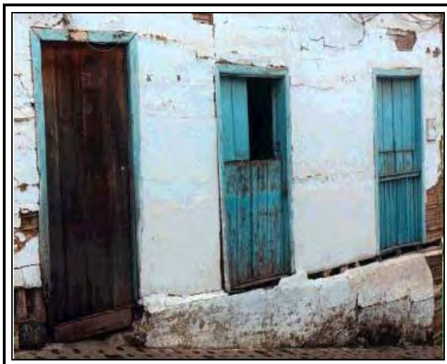
Daños por humedad en recubrimiento
