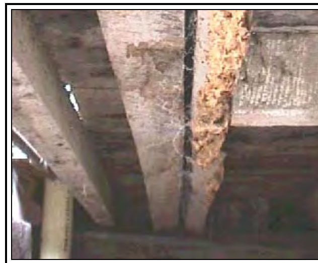
Viga de madera atacada por insectos xilófagos
