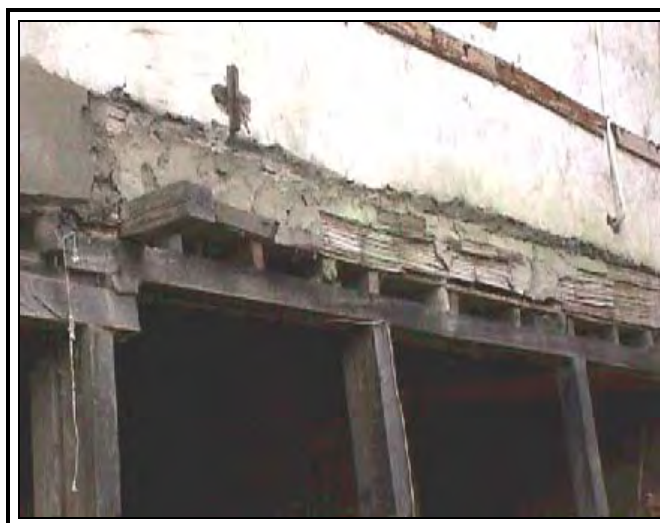
Pudrición por falta de recubrimiento
