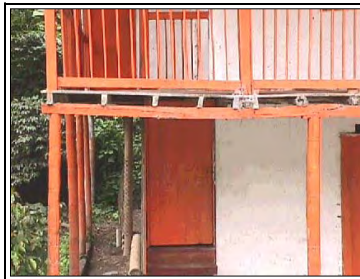
Flexión de elemento por longitud excesiva para el tamaño de la sección
