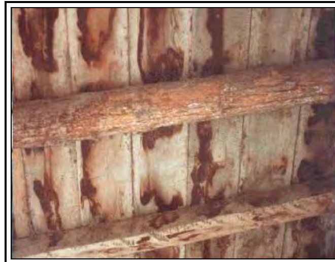
Pudrición de entrepiso por humedad
